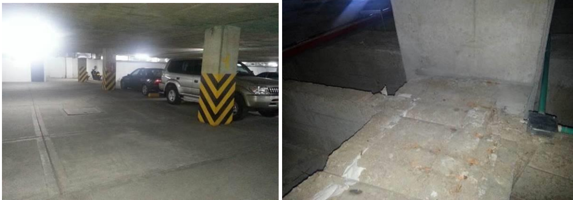
Fig.#79 Estribos de vigas sin recubrimiento presentan oxidación
