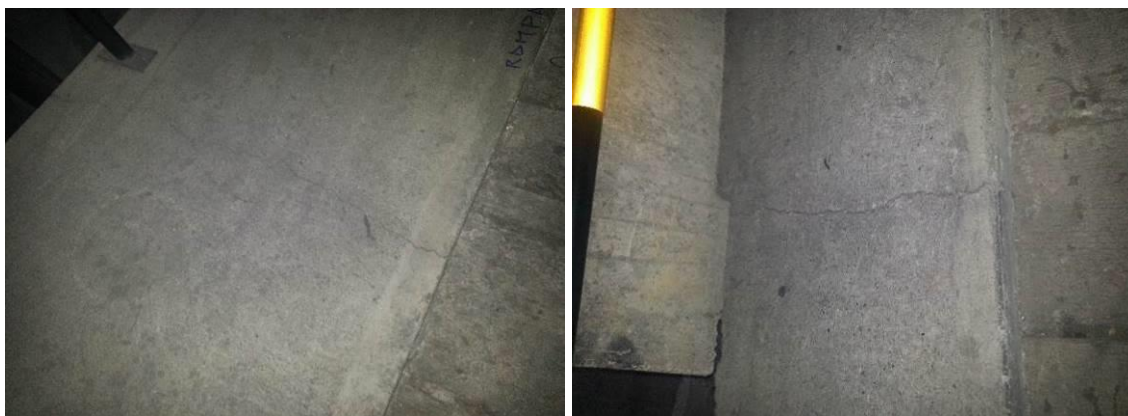
Fig.#66 fisuras en rampa de tránsito en andenes por la falta de juntas de dilatación
