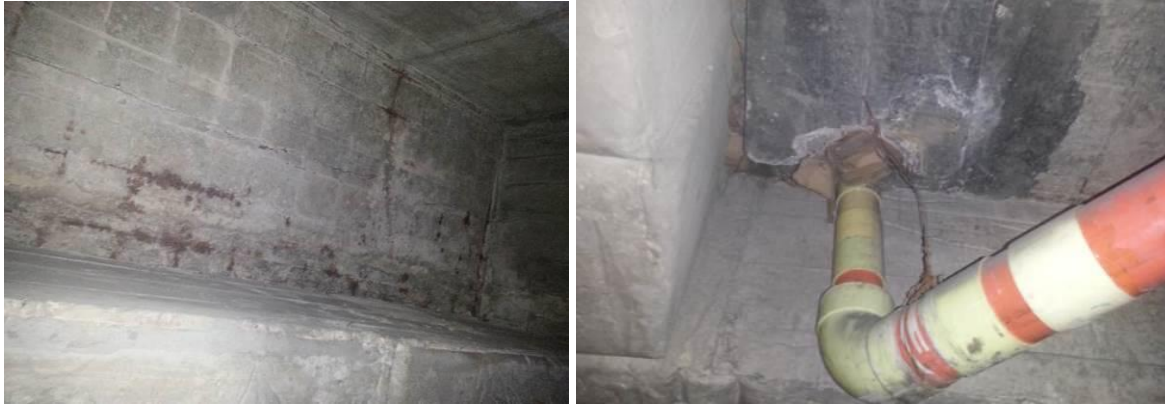
Fig.# 28 Oxidacion de la malla electrosoldada y humedad en el muro en arcilla
