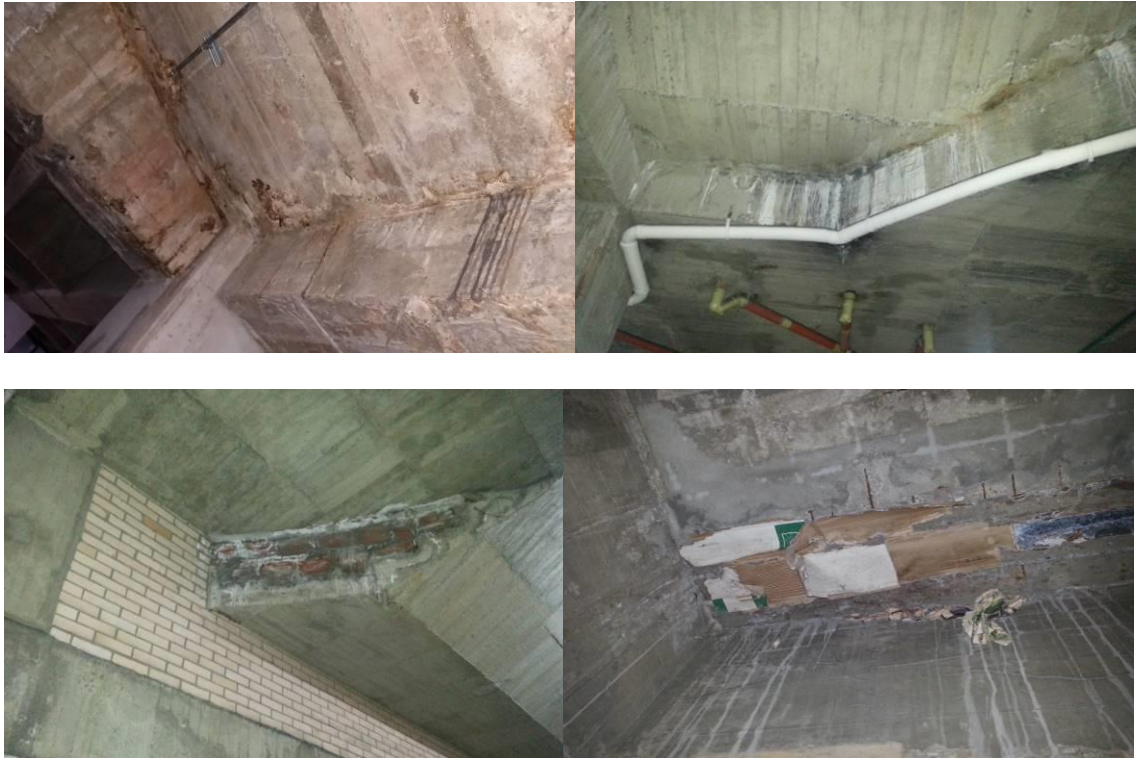
Fig. #127 Eflorescencia en lo concretos
