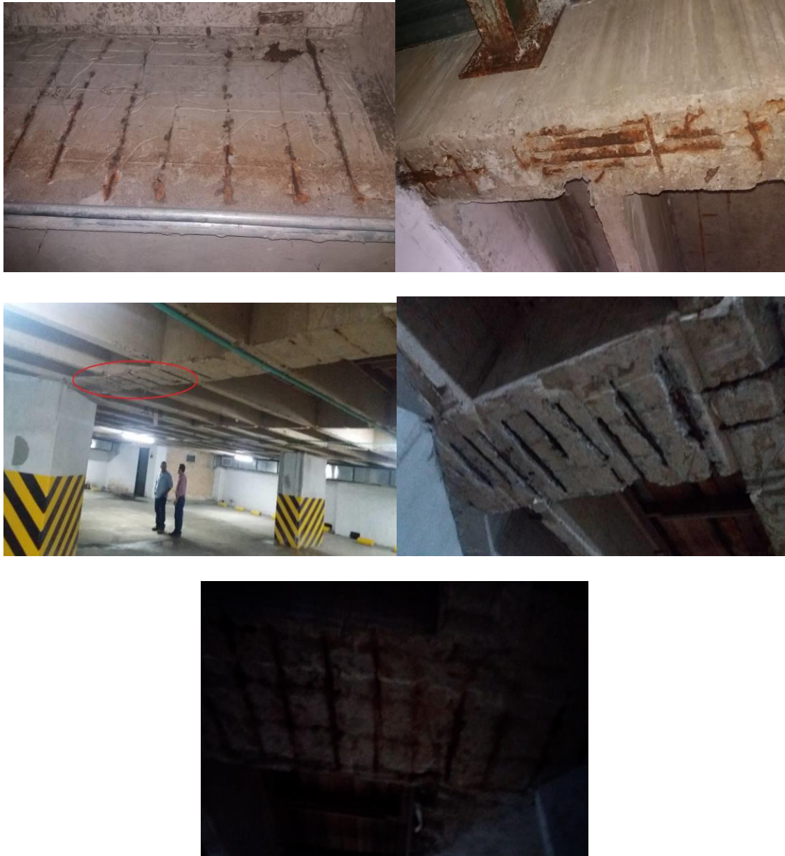
Fig. #124 corrosión de la vigas
