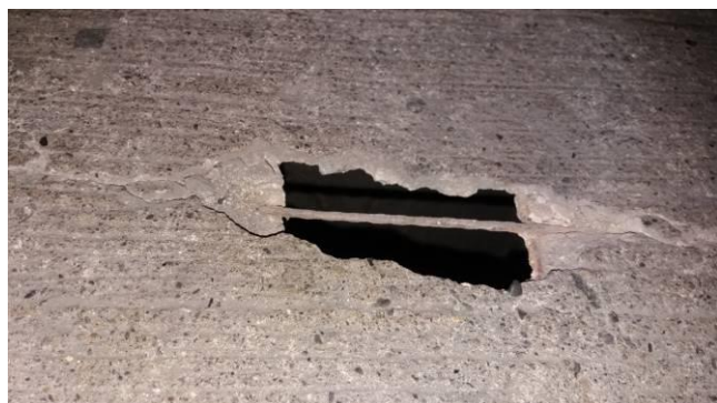
Fig. #133 deterioro de la placa de rodadura
