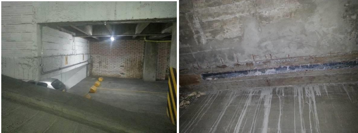
Fig. #26 Muros deteriorados por el accionar de las aguas de nivel freático y flujo del agua por entre las losetas del entrepiso
