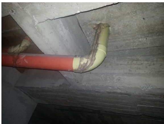
Fig.# 71 Ausencia de cintas de anclaje para la tubería de desagüe y malla electro soldada superficial que presento oxidación
