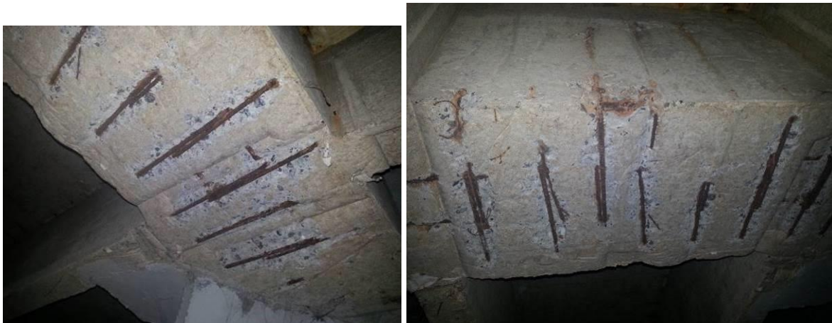
Fig. #29 Estribos de vigas sin recubrimiento expuestos a la intemperie presentaron oxidación. El refuerzo a flexión también se encuentra afectado
