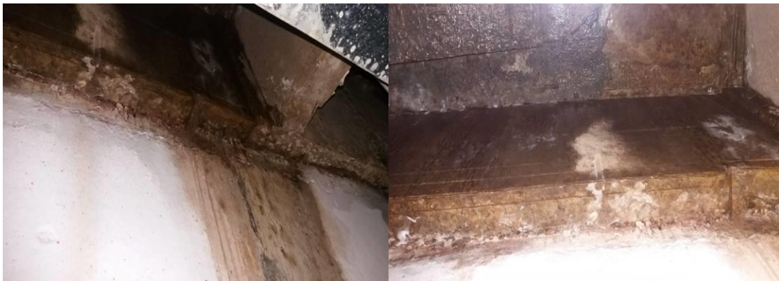
Fig. #126 humedades en la uniones de los concretos
