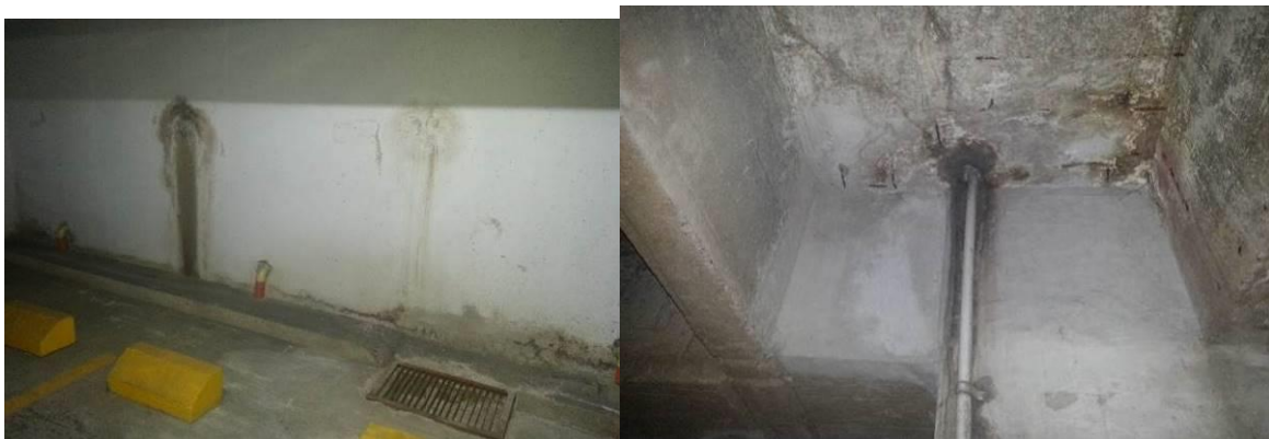
Fig.#78 Humedades en paredes por la presión del agua del nivel freático
