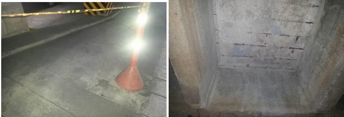
Fig.#76 malla electro soldada a flor de piel ya presento oxidación
