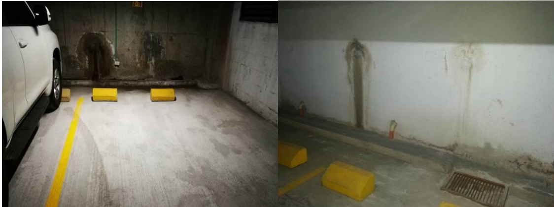
Fig. #131 humedades en muros de contención
