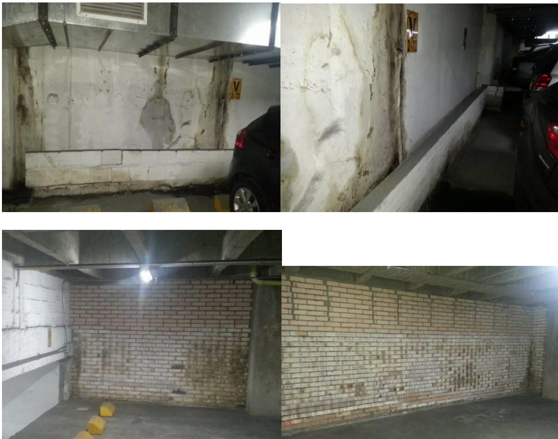
Fig. #132 humedades en muros en ladrillo
