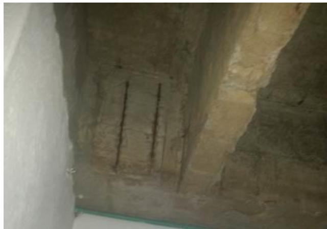
Fig.#77 Estribos de vigas sin recubrimiento se exponen a la intemperie presentando oxidación
