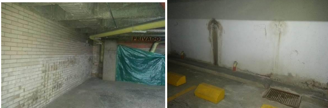
Fig.# 25 Humedades en paredes y suciedades
