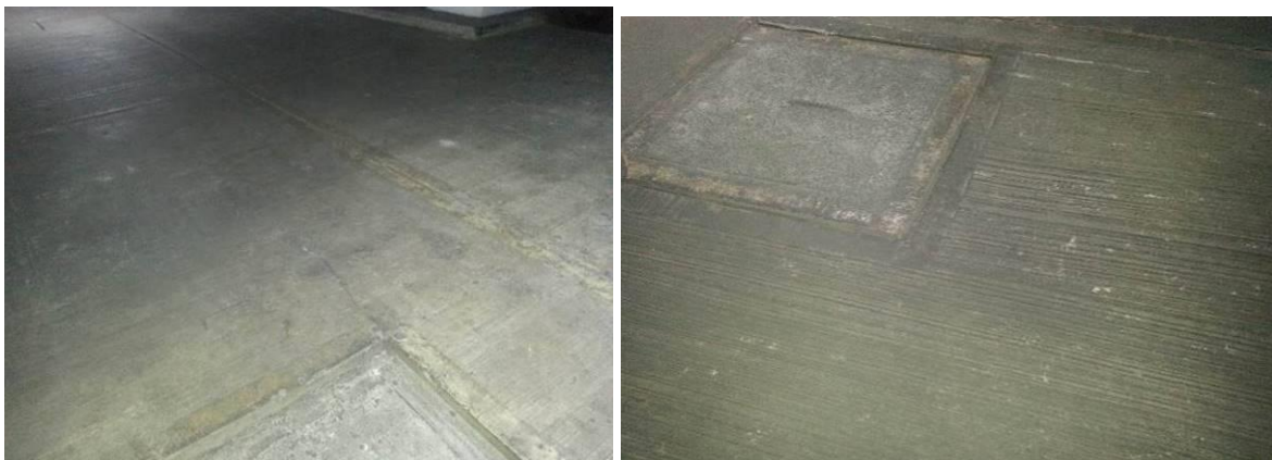
Fig.#81 Tapas de cajas domiciliarios a desnivel con respecto al piso y fisuras en el piso
