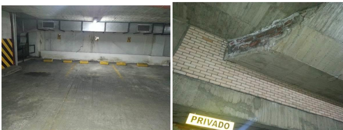
Fig.#68 Humedades en los muros de cerramiento en ladrillo
