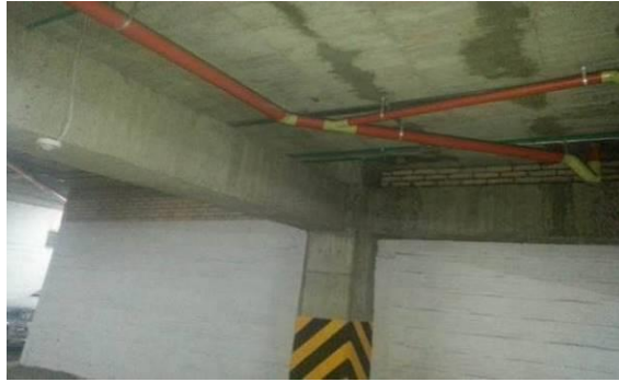
Fig. #69 Escasez de cintas de anclaje para la tubería de desagüe
