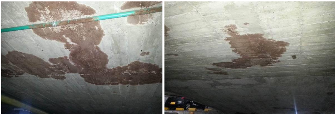
Fig.#27 Eflorescencia y presncia de hongos en el cielorazo(torta en concreto9 de losa de entrepiso
