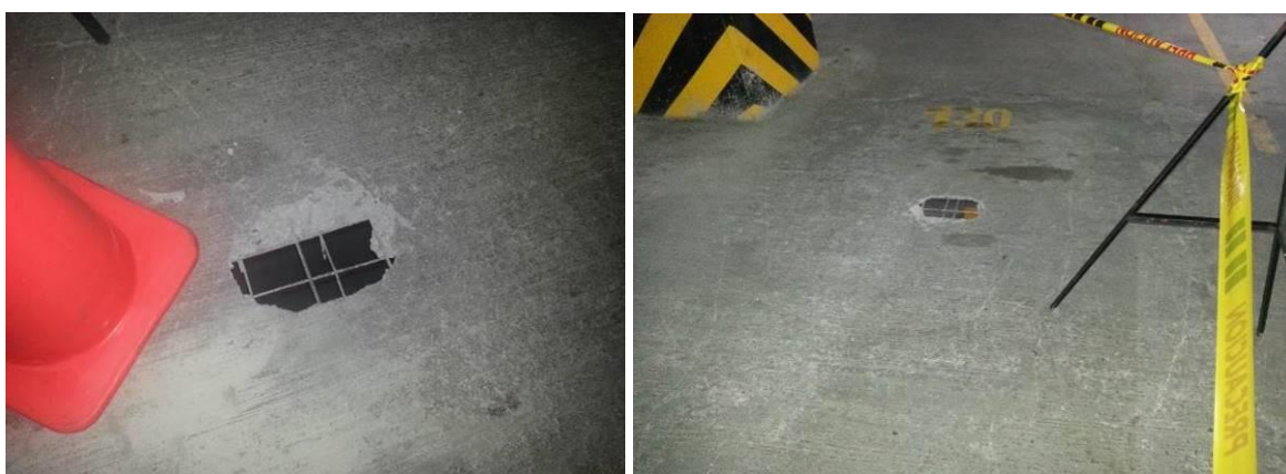
Fig.#67 Deterioro de loseta por tipo de agregados pétreos de ½" espesor de loseta (<4 cm)
