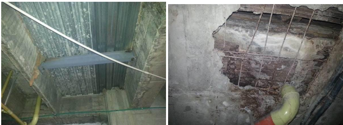
Fig.#65 Deterioro de los casetones en áreas de losa por acción del agua, se aprecia la malla electro soldada totalmente oxidada
