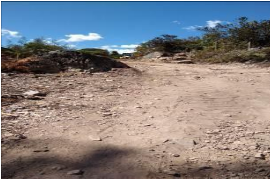
Figura 6. Estado del tramo 4 antes de su intervención-Vereda San Francisco
