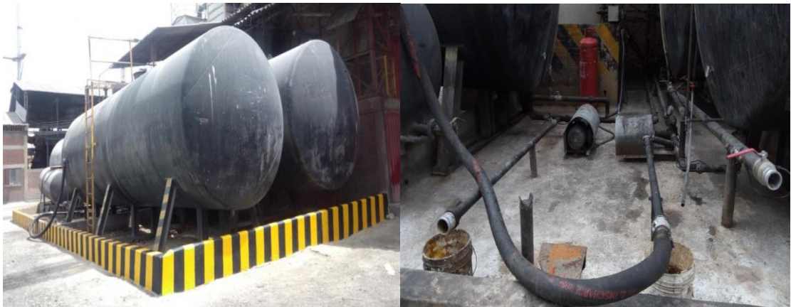
Imagen 12: Tanques de Almacenamiento Materia Prima Liquida
