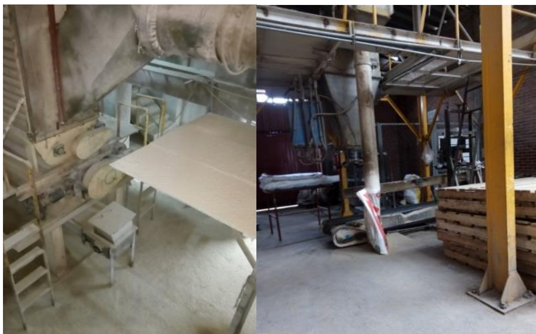
Imagen 8: Planta de producción (quebrantadores - empaque)
