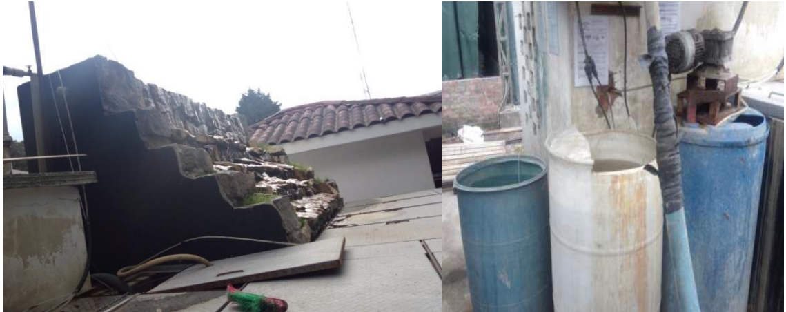
Imagen 2: PTAP (Planta de tratamiento agua potable)
