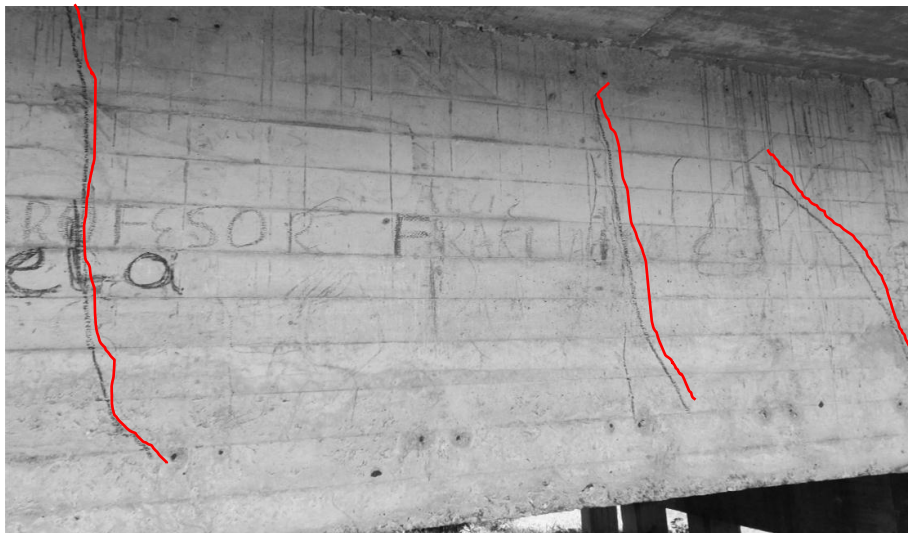
Figura 27. Fisuras en las vigas.
