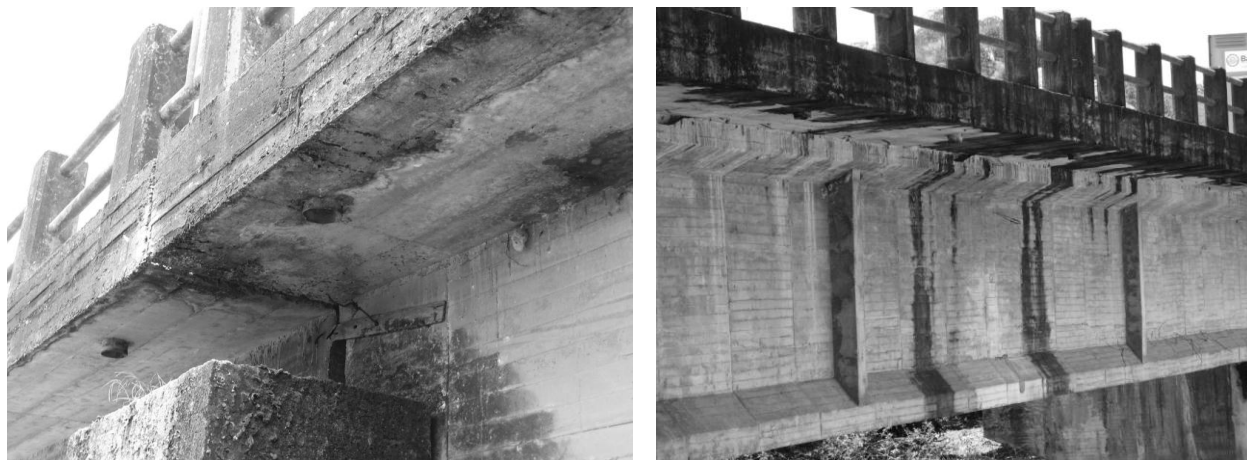
Figura 23. Detalle viga aguas arriba (a) Humedad, suciedad. (b)Contaminación vegetal.
