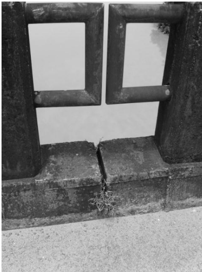
Figura 19. Tubos longitudinales con corrosión. Vegetación en junta de bordillo.
