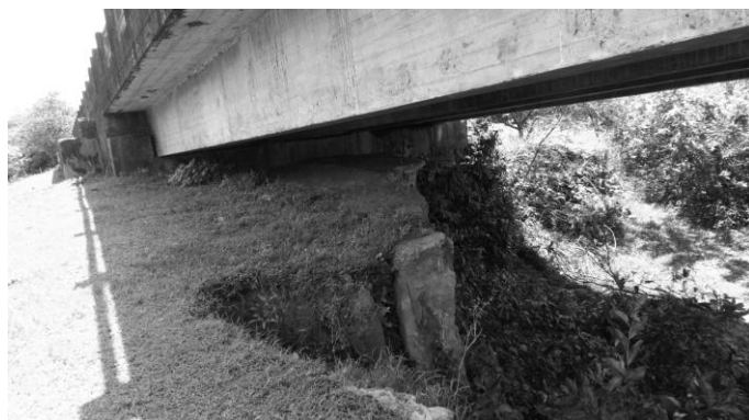
Figura 29. Erosión cerca a estribo del costado Puerto Gaitán.
