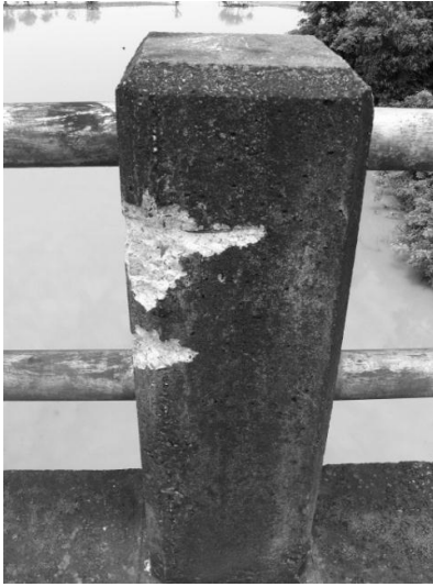
Figura 18. Desprendimiento de concreto y acero con corrosión en pilastra.
