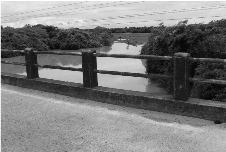
Figura 16. Estado actual de las barandas vista interna.
