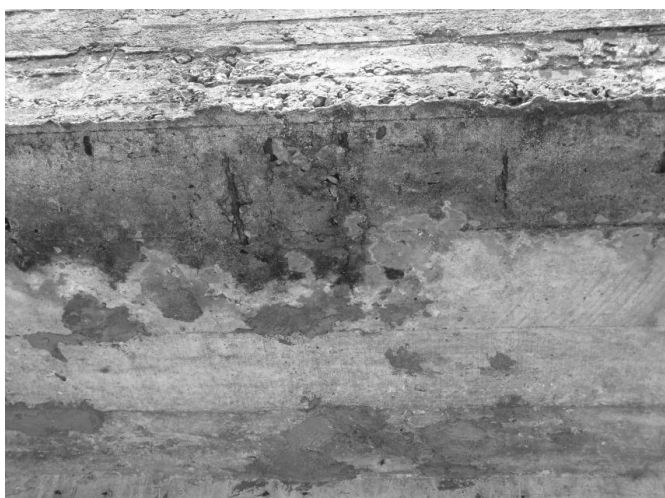
Figura 21. Desprendimiento de concreto, acero con corrosión, humedad.
