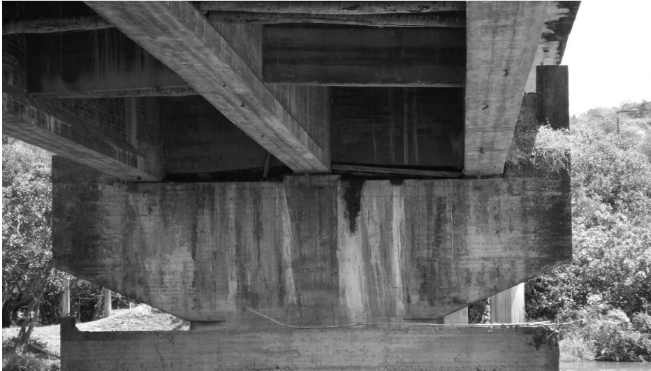
Figura 25. Cristalización de sales solubles, humedad, suciedad.
