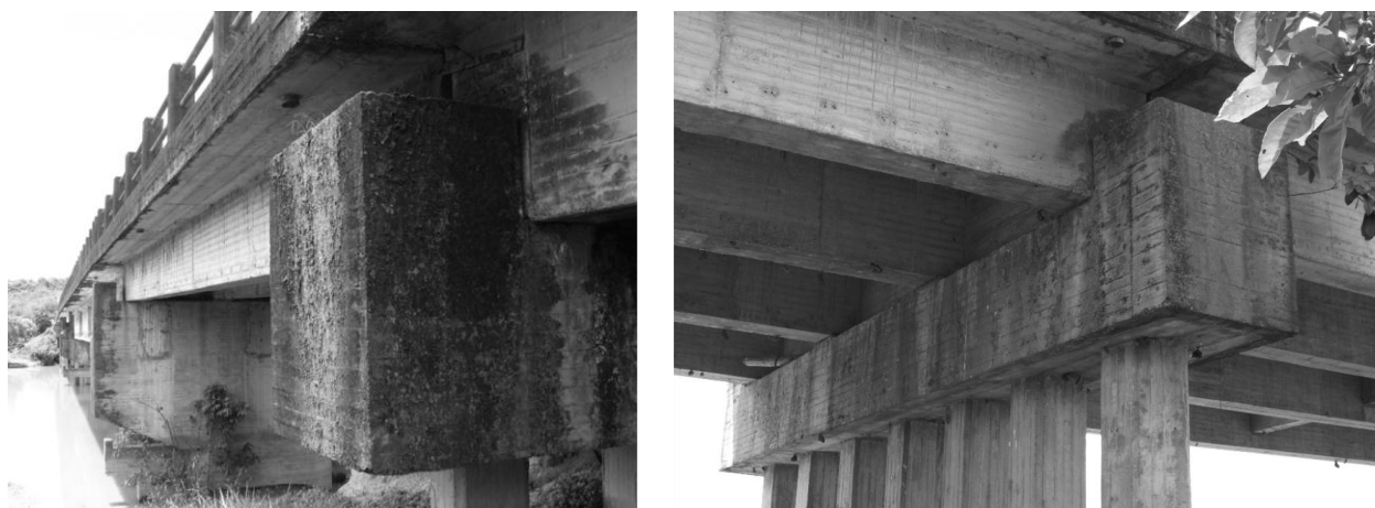
Figura 24. Detalle viga cabezal (a) Contaminación vegetal. (b) Humedad, suciedad.
