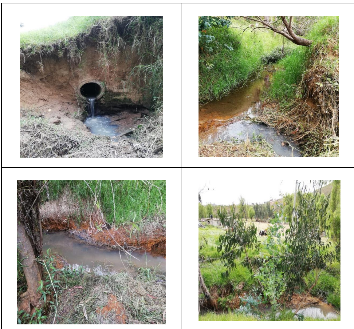
Imagen 6, 7, 8 y 9: estado del vertimiento.
