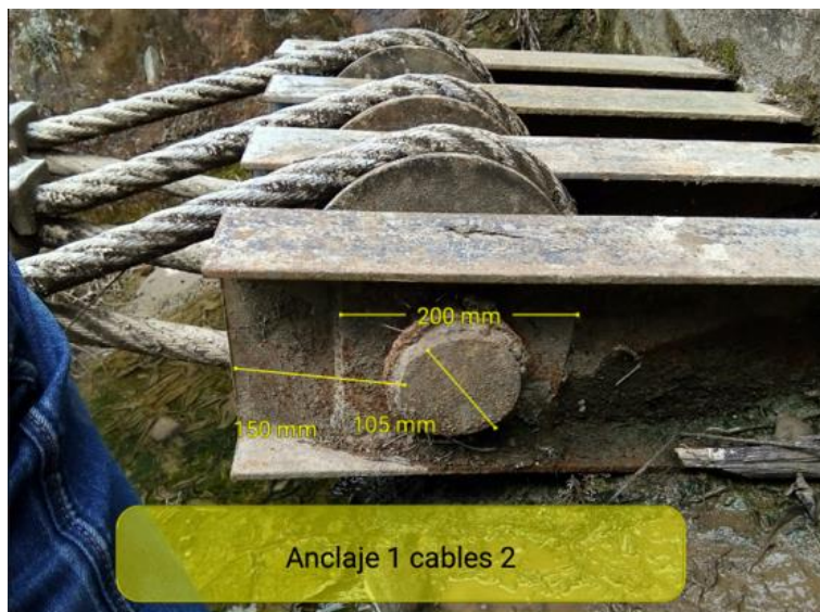
Figura 25. Pasador herraje de anclaje cables de \varnothing 1\ 5/8'' . Elaboración propia.
