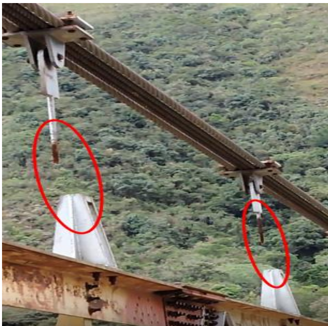
Figura 39. Pendolón fracturado. Fuente propia.
