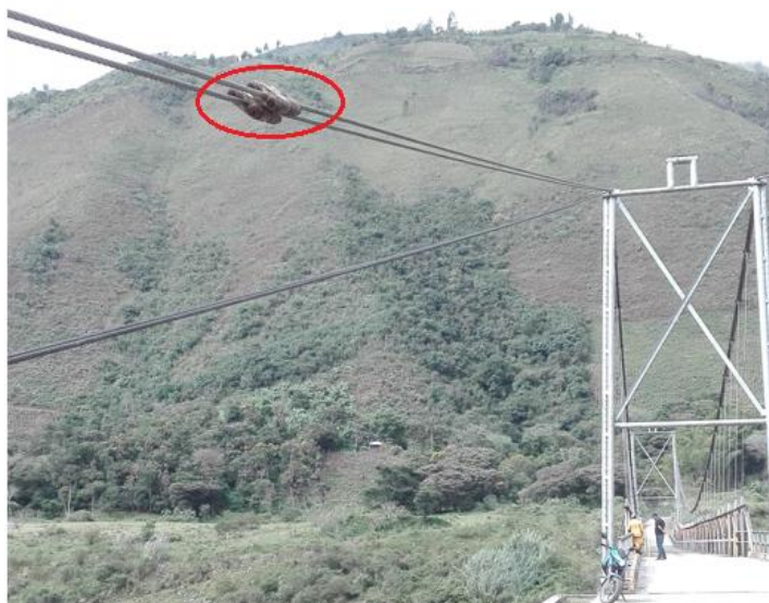
Figura 5. Empalme cable principal. Fuente propia
