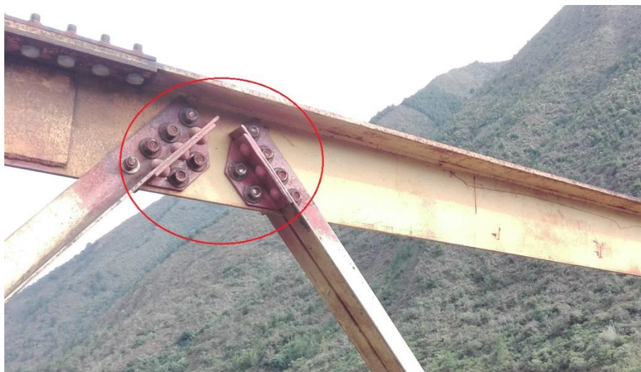
Figura 7. Longitud de pernos inadecuada. Fuente propia
