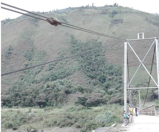
Figura 19. División de grupos de cables al salir de la torre. Fuente propia
