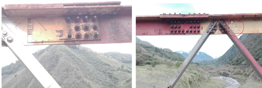
Figura 6. Elemento con reproceso en obra. Fuente propia
