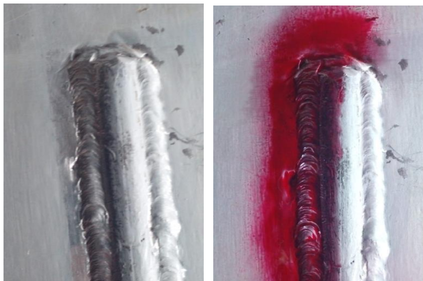
Figura 48. Limpieza y aplicación del líquido penetrante al pendolón
