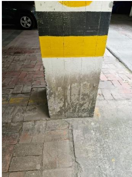
Ilustración 49. Suciedad presentada en elementos de Sótano. fuente propia
