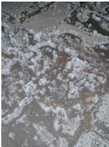
Ilustración 48. Hongo presente en adoquines. Fuente propia.
