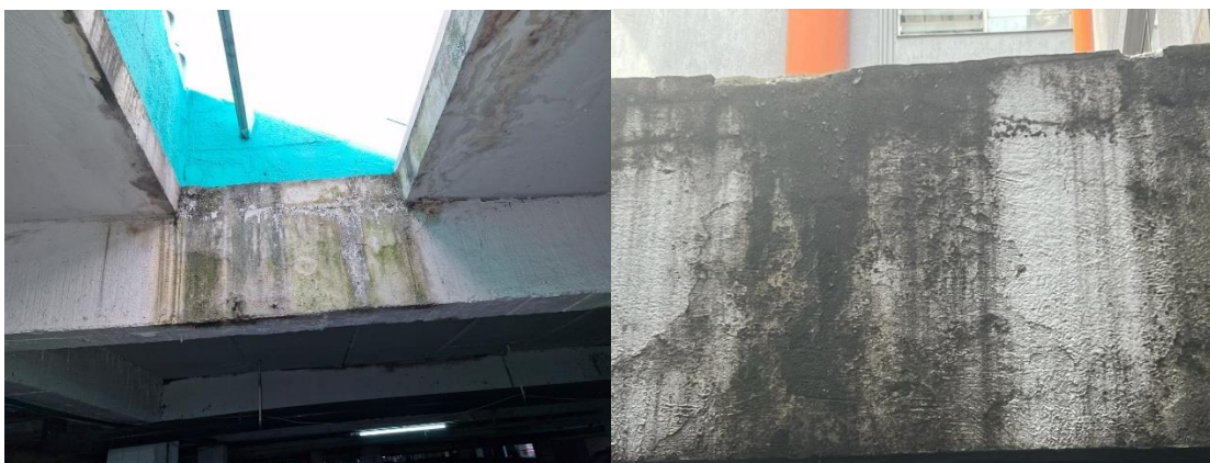
Ilustración 46. Erosión y descomposición. fuente propia
