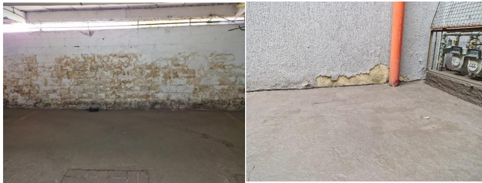
Ilustración 43. Humedades ascendentes y por capilaridad. Fuente propia
