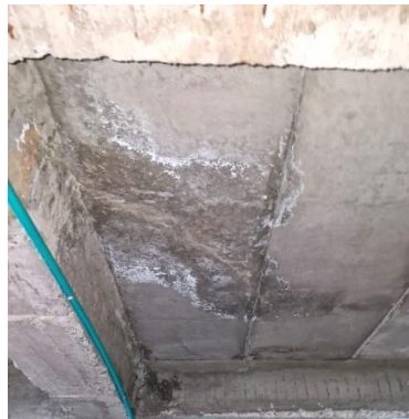
Ilustración 45. Presencia de eflorescencias en prelosas. Fuente propia. (Conjunto Rincón de Techo II Ilustración, 2024)
