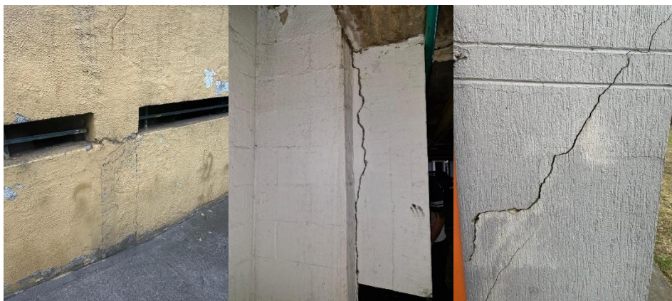
Ilustración 42. fisuras y grietas. Fuente propia
