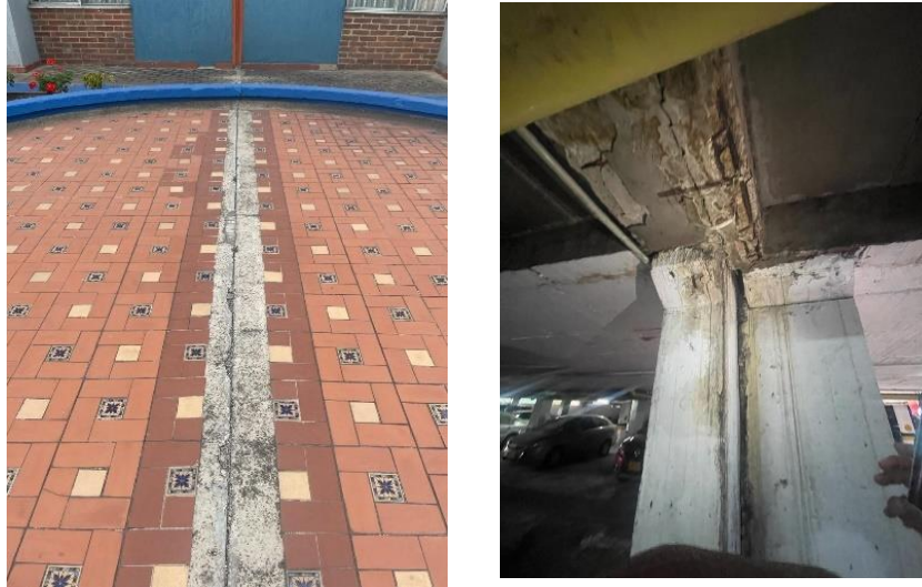
Ilustración 39. Filtración por junta constructiva. Fuente propia
