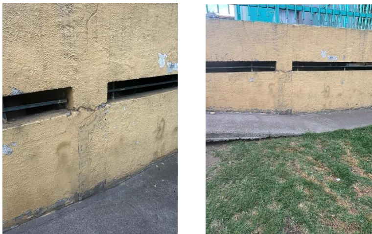
Ilustración 47. Columna corta en semisótano. Fuente propia
