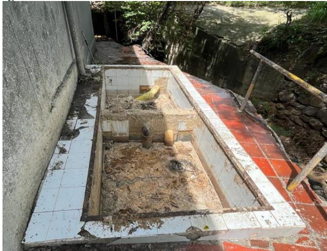
Figura 17. Trampas de grasa sin mantenimiento
