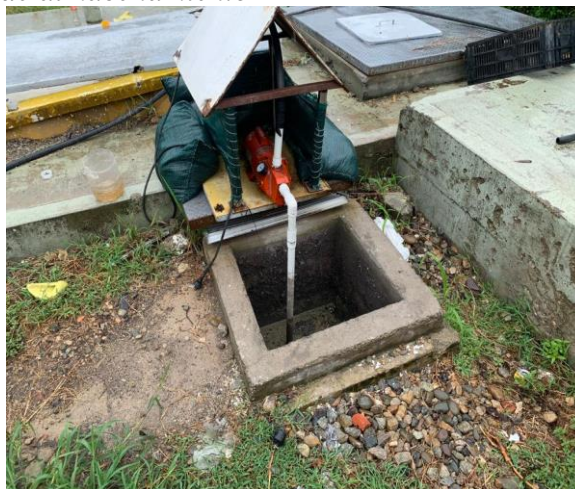
Figura 28. Bomba y caja de almacenamiento
