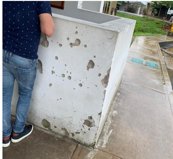
Figura 22. Fachada afectada, toma 2
