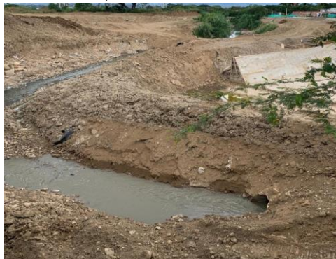
Figura 35. Vertimiento de alcantarillado, toma 2
