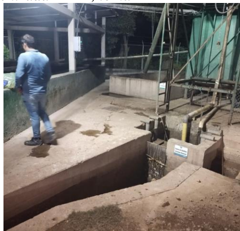
Figura 41. Toma de muestra entrada PTAR, toma 2
