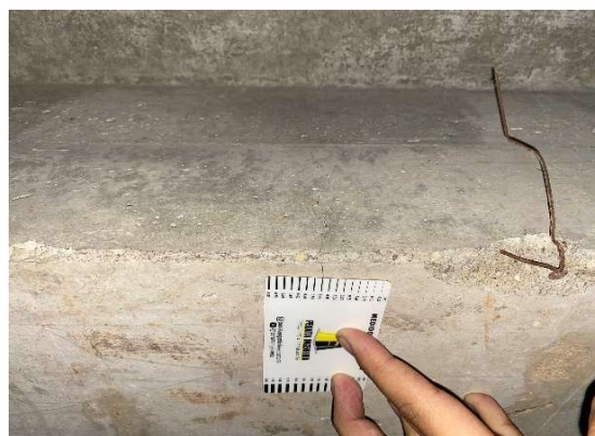
Foto 3. Fisura en viga VG-4 sótano 2
