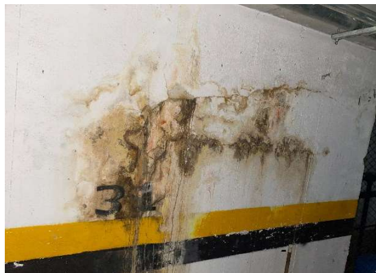
Foto 3. Muro afectado por humedad sótano 2
