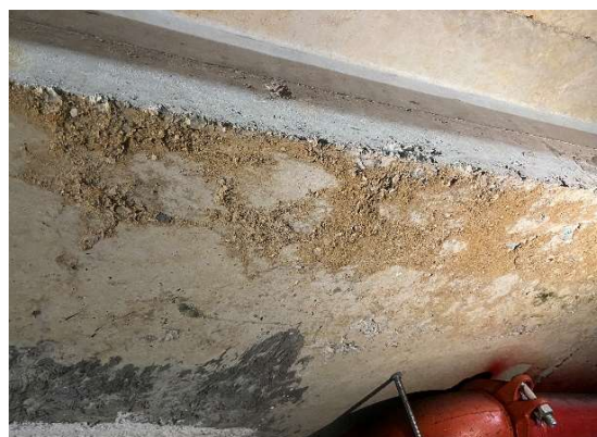
Foto 3. Material no íntegro Viga VDE sótano 2
