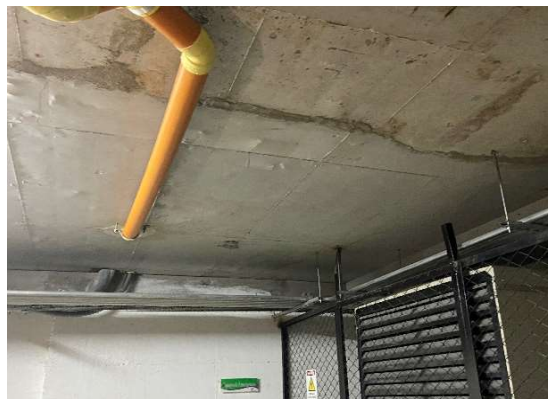
Foto 3. Fisura en placa sótano 2
