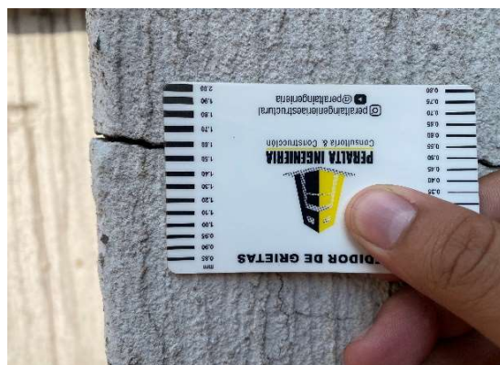
Foto 3. Muro no estructural parque infantil
