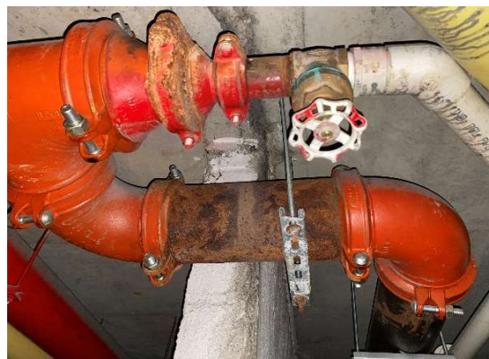
Foto 2. Corrosión tubería RCI sótano 2
