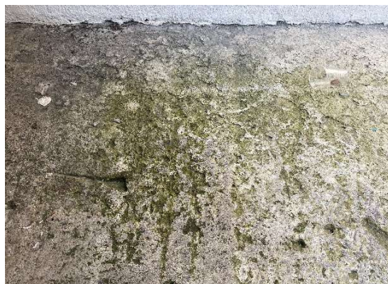
Foto 3. Placa parqueaderos nivel +1,25 piso 1
