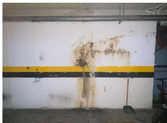
Foto 2. Muro afectado por humedad sótano 2
