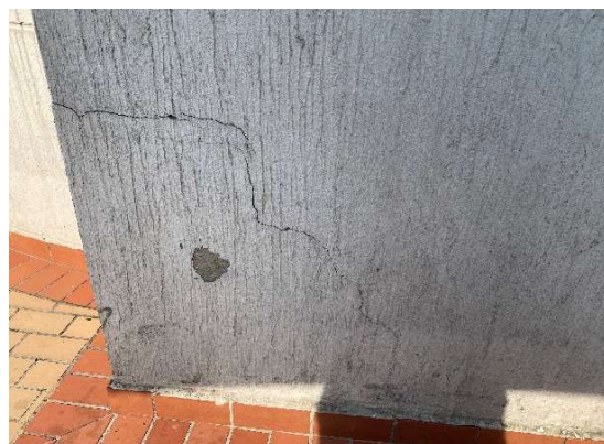
Foto 2. Muro no estructural parque infantil
