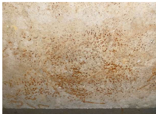
Foto 3. Viga VG-D placa nivel +1,25 sótano 1
