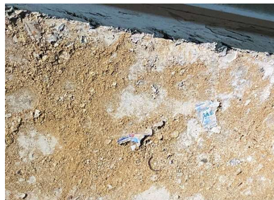
Foto 2. Material no íntegro Viga VDE sótano 2
