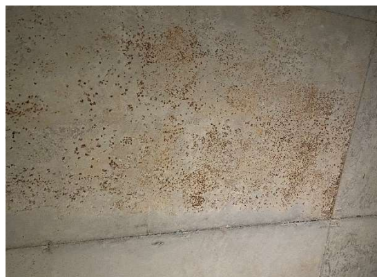
Foto 2. Viga VG-D placa nivel +1,25 sótano 1
