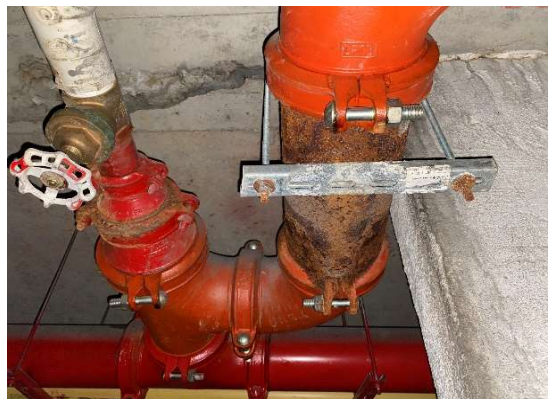
Foto 3. Corrosión tubería RCI sótano 2
