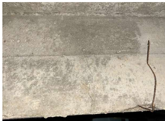
Foto 2. Fisura en viga VG-4 sótano 2
