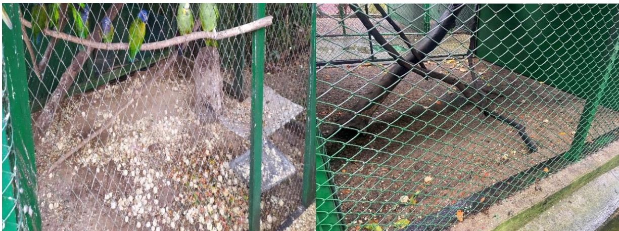
Figura 18. Falta de mantenimiento en Jaulas
