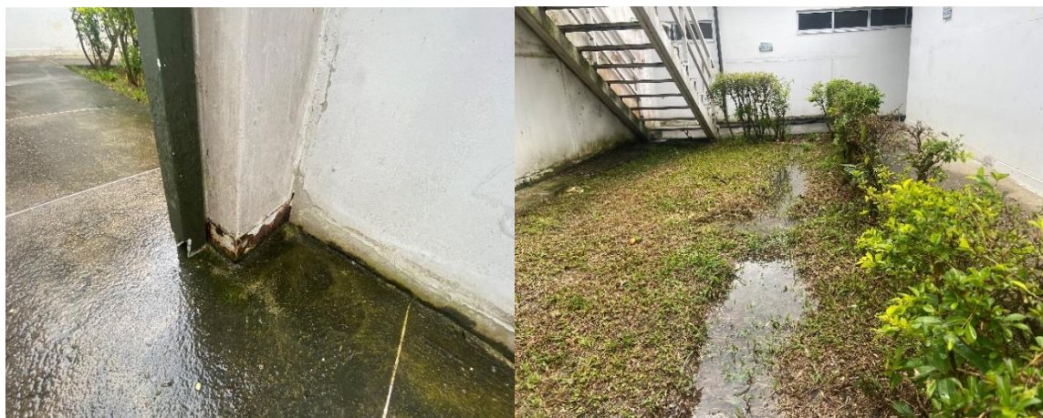
Figura 19. Falta de manejo aguas lluvia
