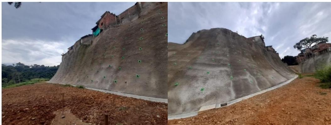
Figura 51. Vista sistema de recolección de aguas lluvia
