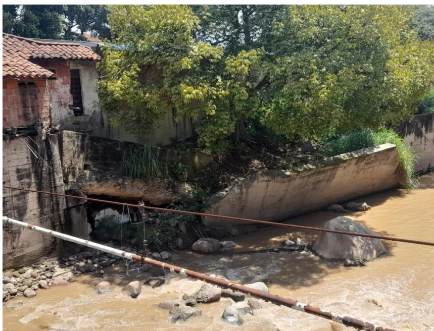
Figura 12. Muro colapsado Puente Lenguerke
