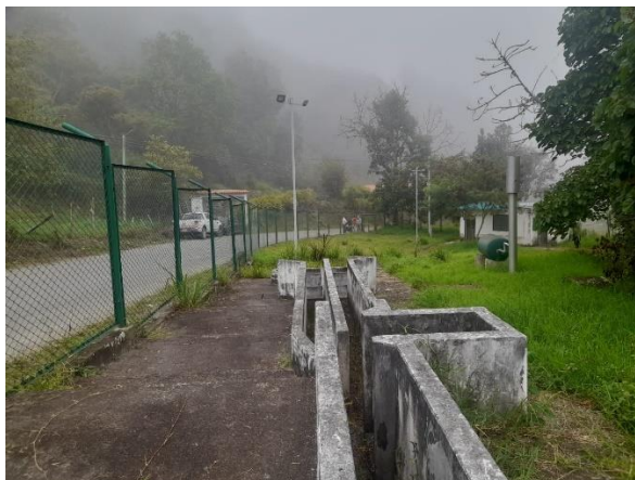
Figura 20. Canaleta Parshall PTAR Tona
