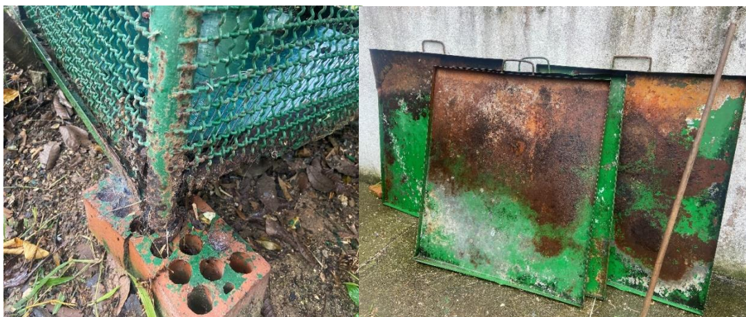
Figura 16. Corrosión elementos de las Jaulas
