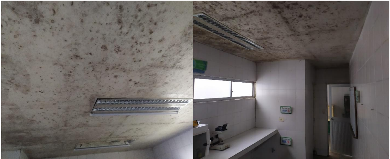
Figura 17. Afectaciones en el techo
