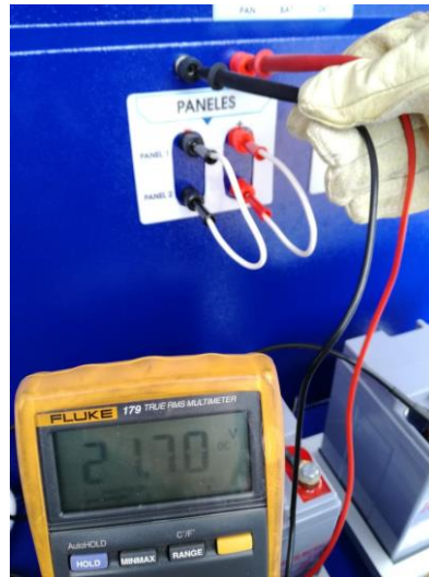
Figura 69. Medición de voltaje pico de paneles conectados en paralelo.
