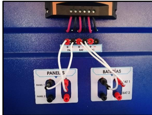
Figura 72. Conexión de batería y panel a inversor.
