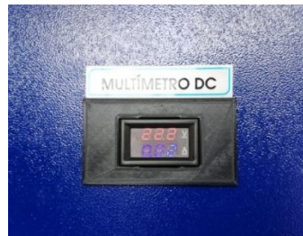
Figura 68. Valor de voltaje pico de paneles mostrado por multímetro digital DC.
