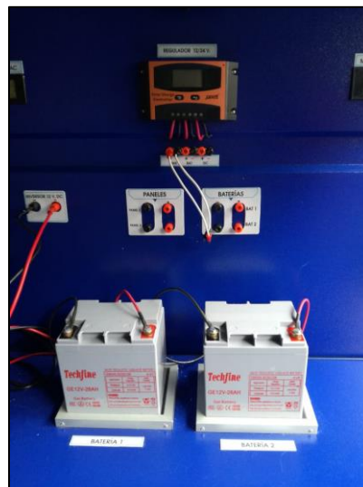
Figura 64. Conexiones con su respectiva señalización.
