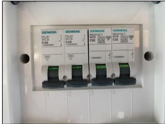
Figura 16. Ilustración de la caja de protecciones.
