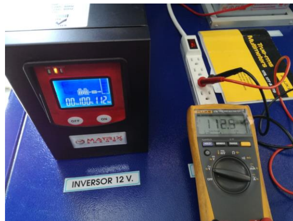
Figura 79. Comprobación de funcionamiento de inversor y salida de voltaje a 110 voltios.
