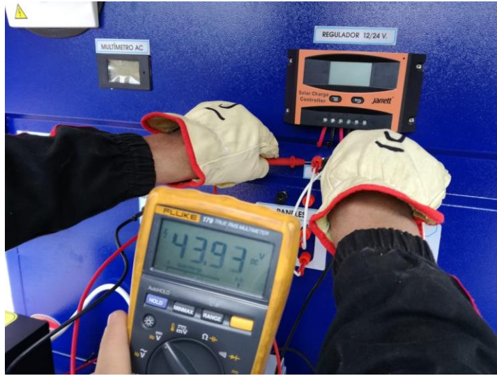
Figura 70. Medición de voltaje pico de paneles conectados en serie.
