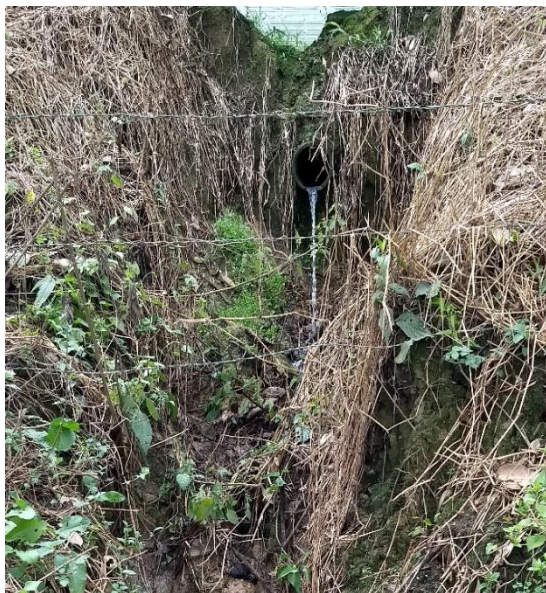
Fotografía No. 14. No hay estructura de alcantarilla
