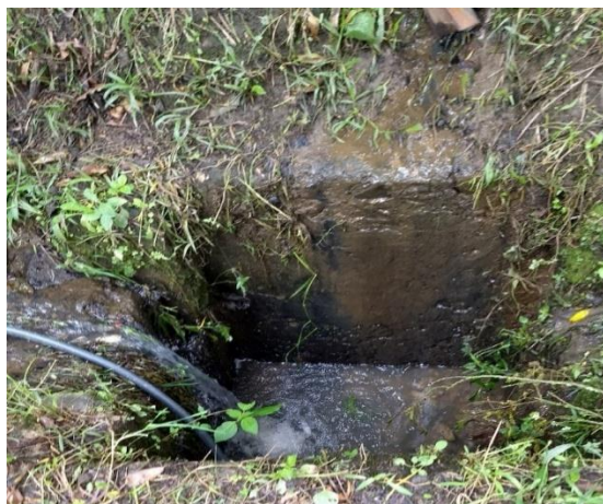
Fotografía No. 18. Alcantarilla sin muro cabezal
