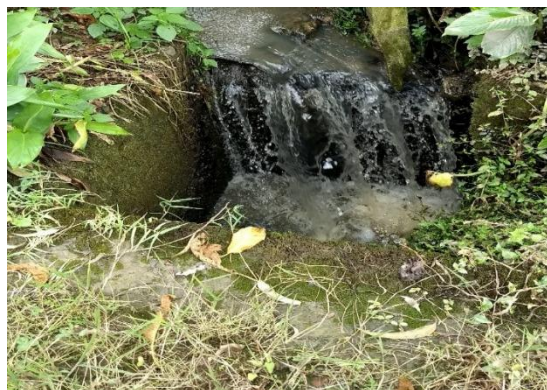
Fotografía No. 16. Alcantarilla sin muro cabezal
