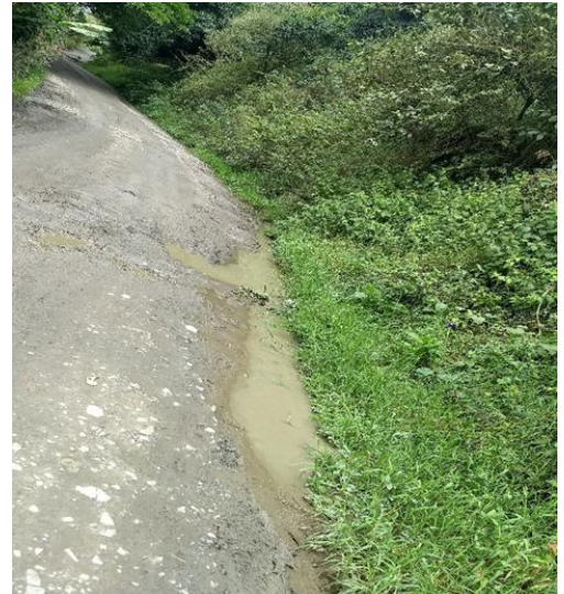
Fotografía No. 25. Costado de la vía encharcado.
