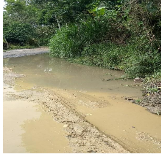
Fotografía No. 6. Se requiere de una alcantarilla
