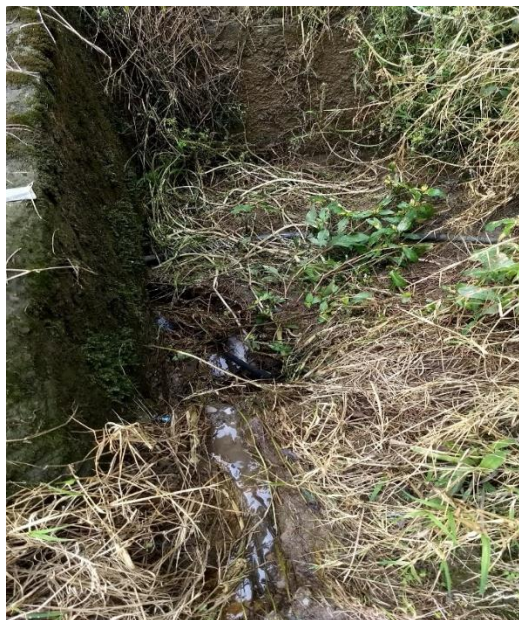
Fotografía No. 9. Alcantarilla cubierta por material vegetal
