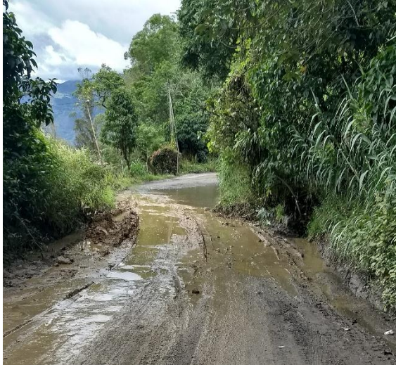
Fotografía No. 5. Superficie de la vía inundada
