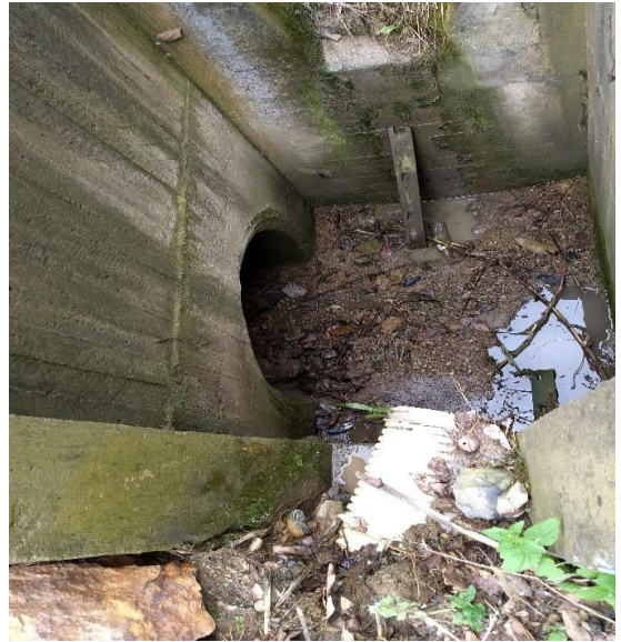
Fotografía No. 21. Alcantarilla con acumulación de material vegetal
