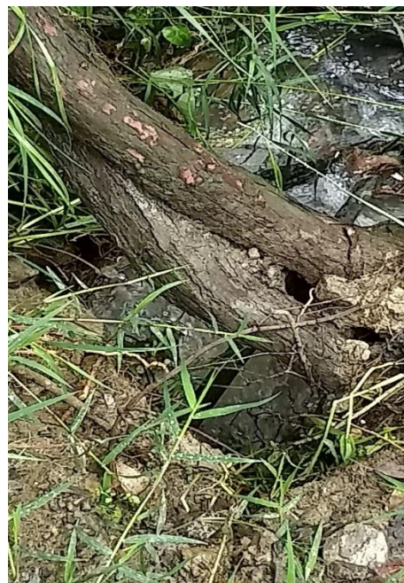
Fotografía No. 4. Descole obstruido por los escombros y material vegetal.
