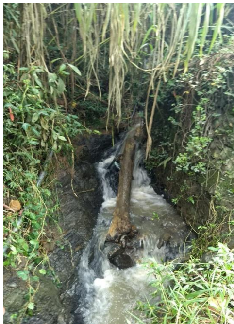
Fotografía No. 3. No hay estructura de alcantarilla
