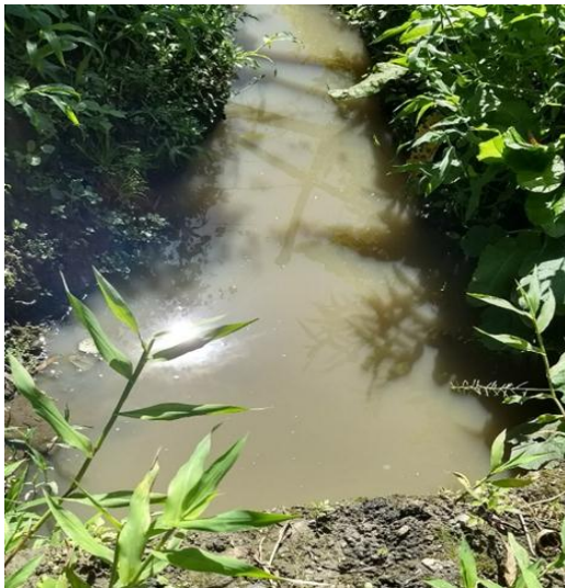
Fotografía No. 24. Taponamiento de la Cuneta
