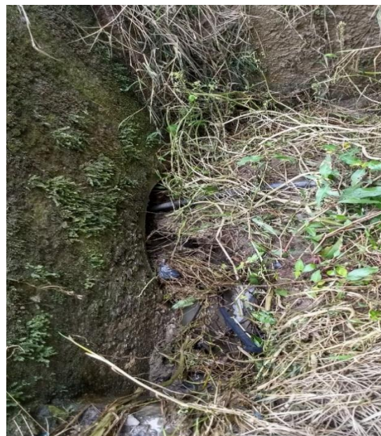
Fotografía No. 10 Tubería de la alcantarilla totalmente tapada
