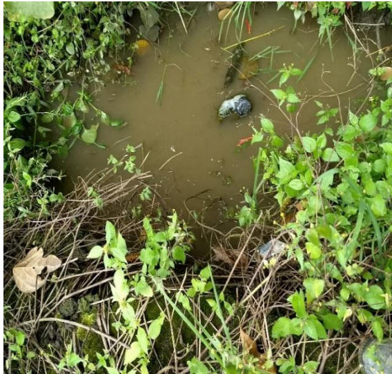
Fotografía 1. No hay una estructura adecuada para la alcantarilla.
