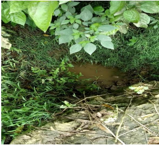
Fotografía No. 22. Alcantarilla fuera de servicio.
