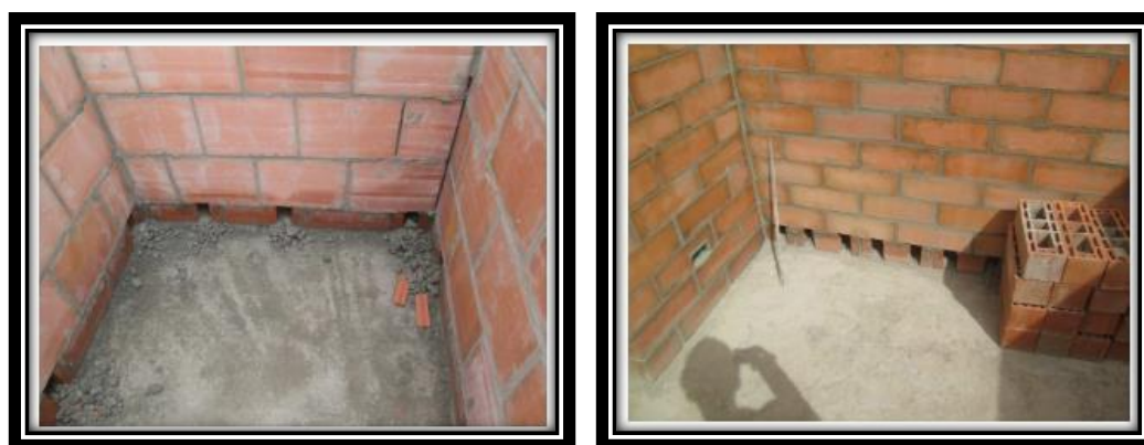
Figura 8. Cavidades de ventanas de inspección o ratoneras.
