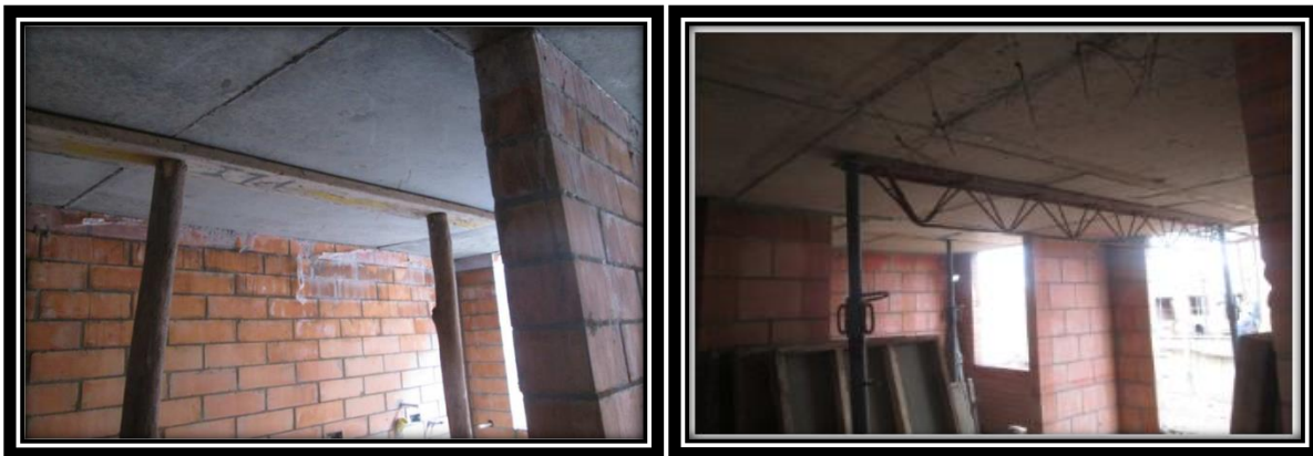
Figura 22. Formaletas en madera poco confiables que no garantizan su trabajo y desarrollo, por su parte la estructura metálica, aunque de mejores condiciones, no cumple certificado de calidad. Urbanización La Gloria, Florencia - Caquetá.
