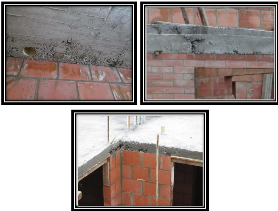
Figura 23. Zonas que fueron identificadas como fallo por hormigoneros en el concreto. Urbanización La Gloria, Florencia - Caquetá.
