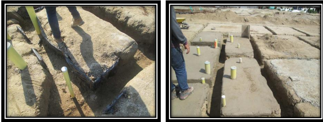
Figura 19. Trincheras de excavación de cimentación inestables, en las cuales fue necesario realizar un tablestacado en plástico y fundición de solado para poder estabilizar el terreno, Urbanización La Gloria, Florencia - Caquetá.
