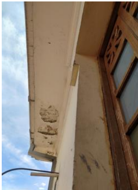
Ilustración 12. Humedad por Afectación Atmosférica
