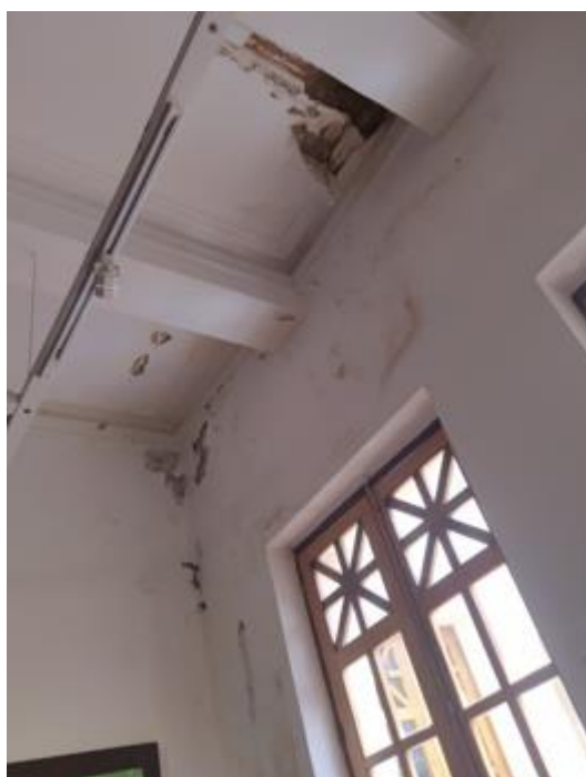
Ilustración 11. Humedad por Filtración
