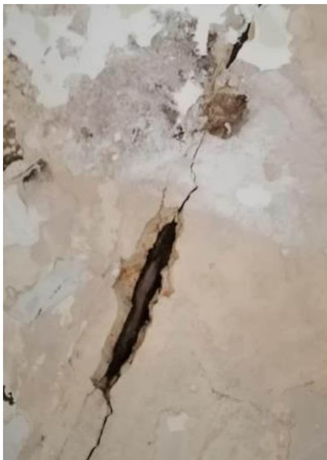
Ilustración 13. Fisura por Asentamiento
