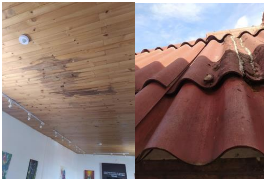
Ilustración 10. Humedad por Absorción
