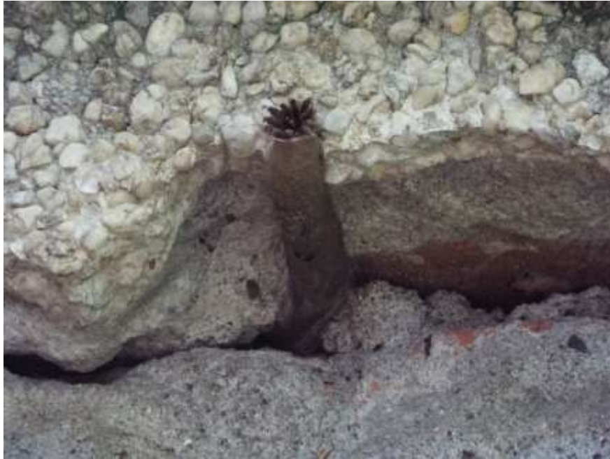
Imagen 42 Nido de insectos en las fisuras
