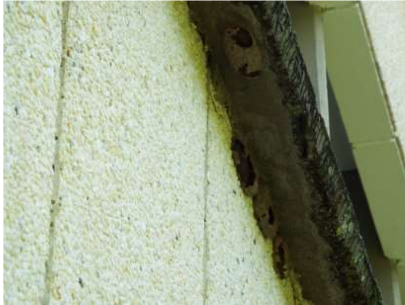
Imagen 47 Presencia de organismos y vegetación en la superficie del concreto
