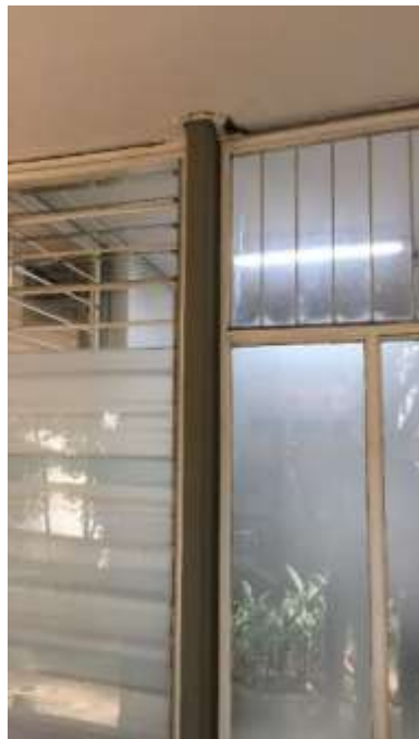
Imagen 18 Desprendimiento de anclaje superior de la columneta de fachada y dilatación de ventana respecto a la losa de entrepiso
