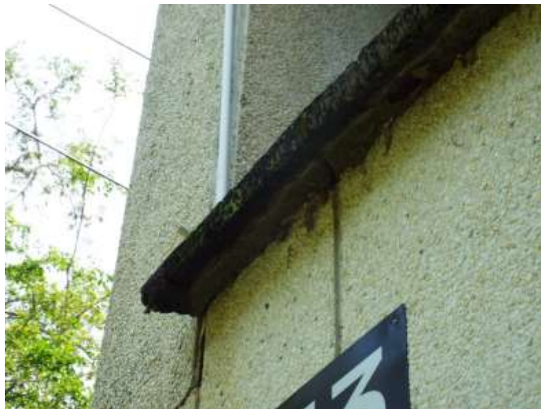
Imagen 43 Desagüe de aire acondicionado sobre la fachada
