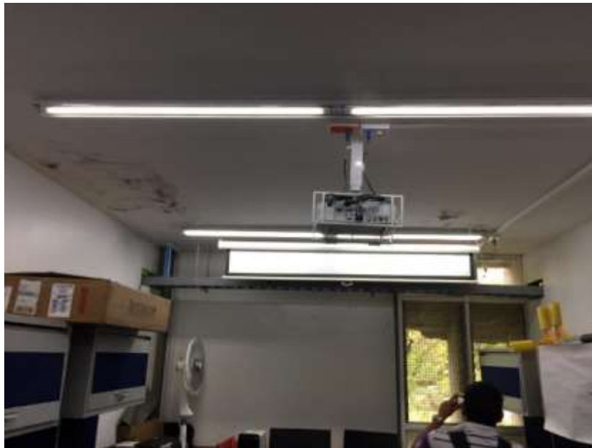
Imagen 27 Humedades afectando espacios de oficinas
