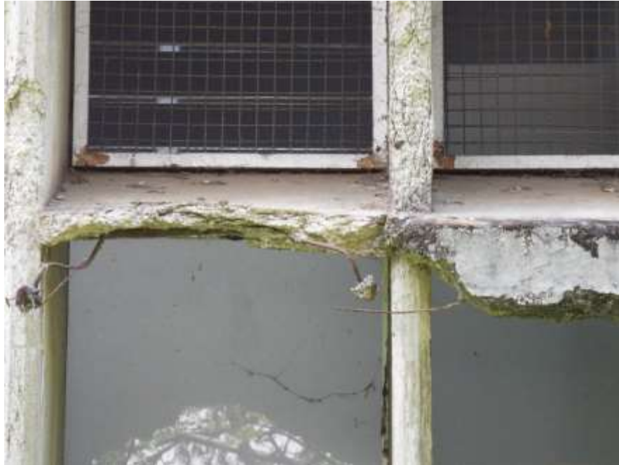
Imagen 45 Presencia de organismos sobre la superficie del concreto
