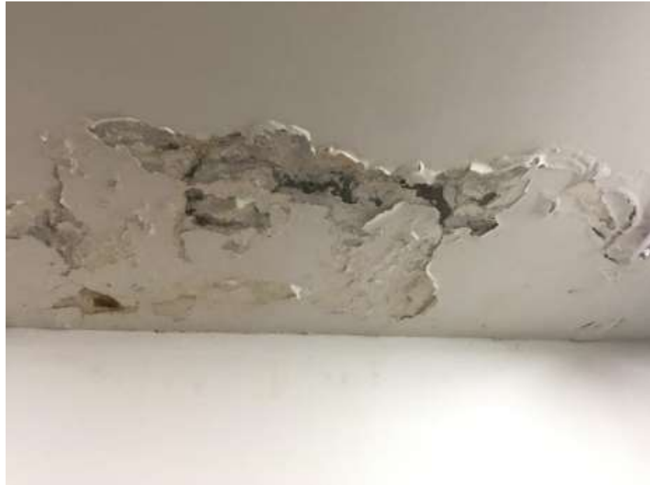
Imagen 25 Humedad severa sobre el cielo bajo la cubierta
