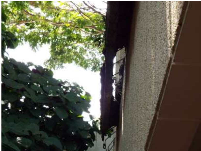
Imagen 15 Perdida del concreto en las alfajías de las ventanas
