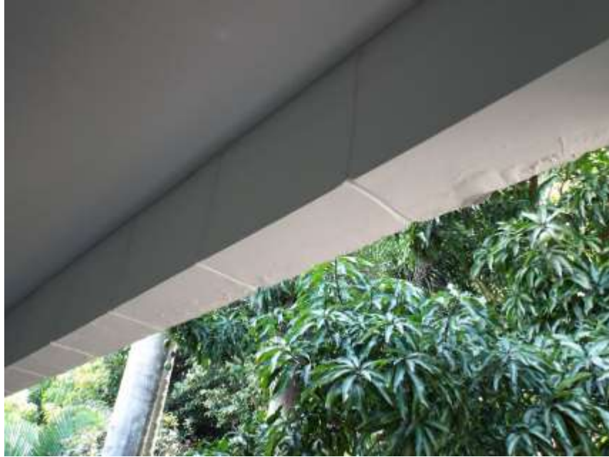
Imagen 54 Humedades por tensión superficial
