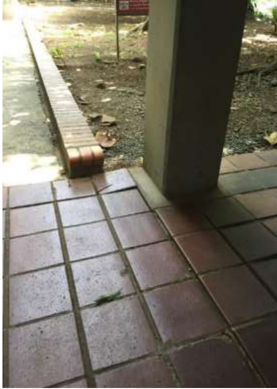
Imagen 24 Desprendimiento de la tableta de enchape del piso
