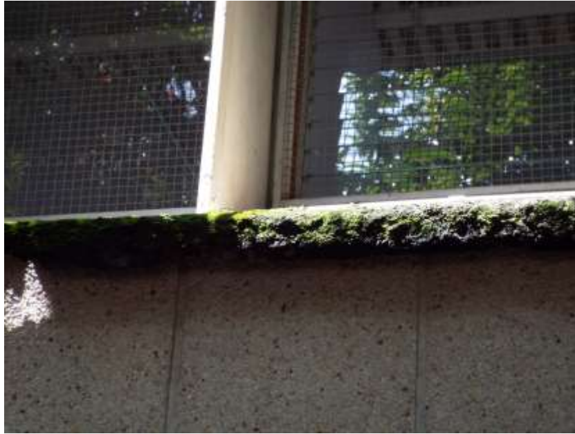
Imagen 17 Alfajía con elementos biológicos y pérdida de concreto
