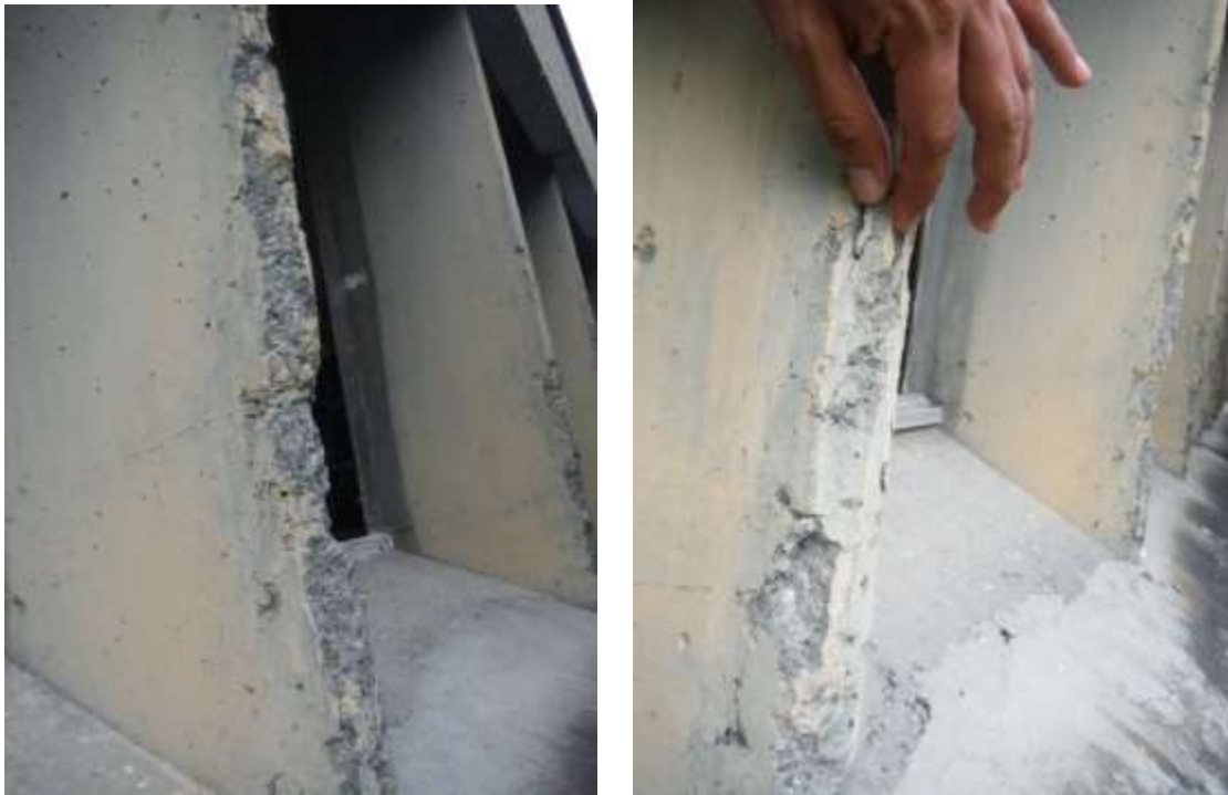
Imagen 14 El concreto deteriorado presenta pérdida de material
