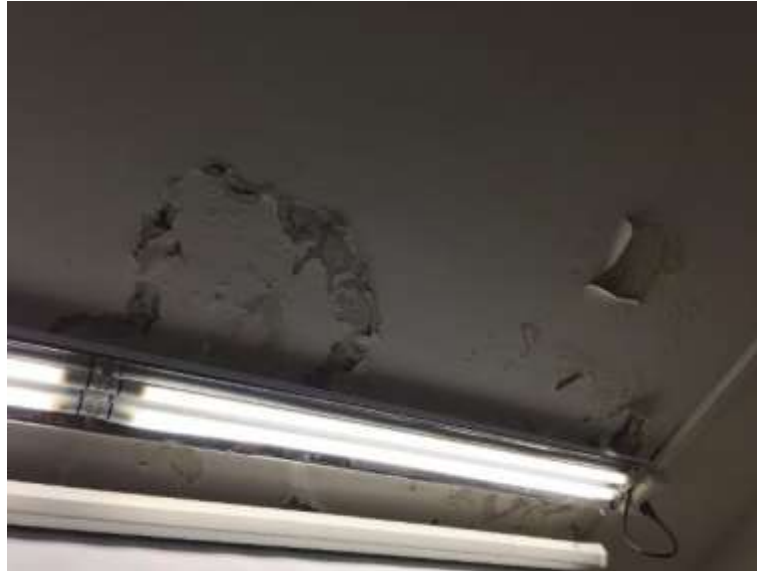
Imagen 28 Humedades sobre elementos eléctricos que pueden ser afectados
