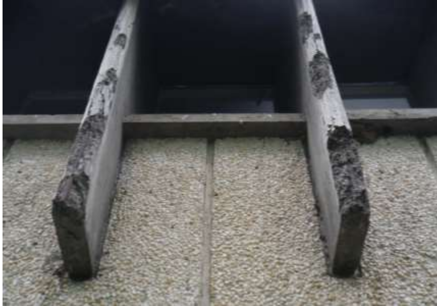
Imagen 44 Pérdida de concreto y acero expuesto
