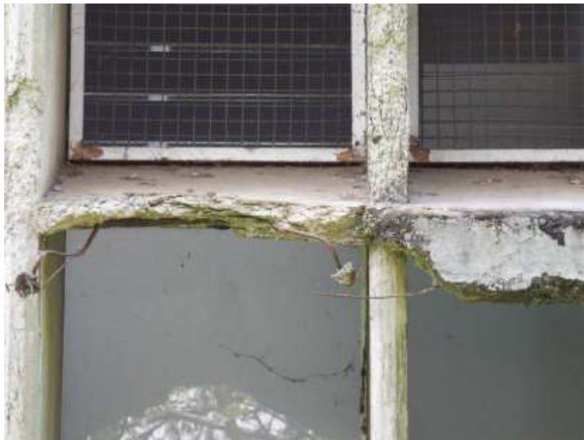
Imagen 13 Detalle del deterioro de los elementos
