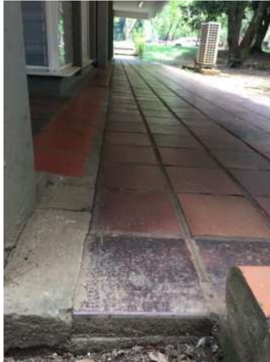
Imagen 22 Cambios de nivel en pisos del área perimetral del edificio
