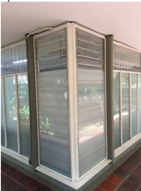
Imagen 21 Desprendimiento de columnetas y carpintería.
