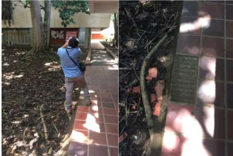
Imagen 34 Árbol de caucho y sus raíces bajo el andén perimetral
