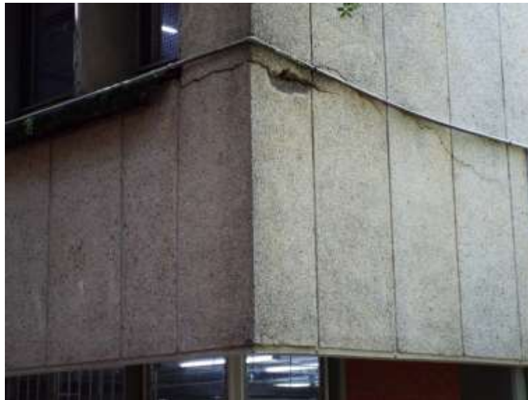
Imagen 10 Grietas en granito y repello en esquina de la fachada
