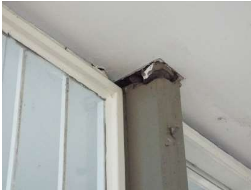
Imagen 20 Desprendimiento de columneta de la losa de segundo piso
