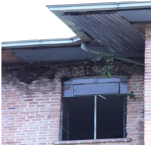
Ilustracion 41 -Detalle redes aguas lluvias en PVC que afectan los muros/fuente consultor
