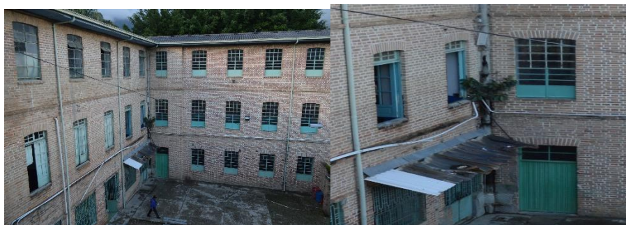
Ilustracion 50 Detalle redes eléctricas patio interior /fuente consultor
