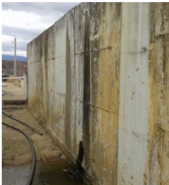
Ilustración 37. Eflorescencia en módulos de PTAP
