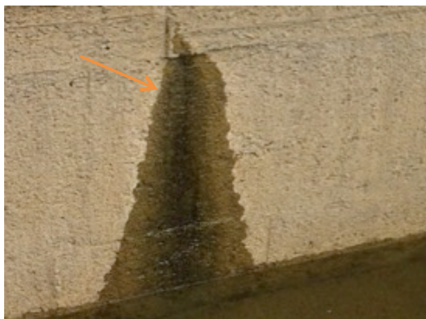
Ilustración 44. Fugas Externa de muros
