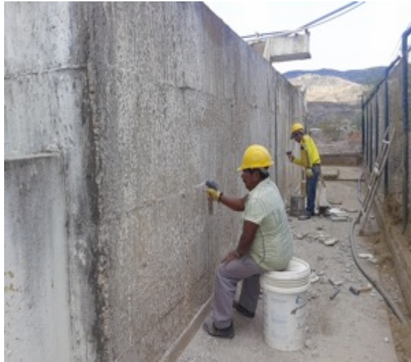
Ilustración 48. Abusardada en muros
