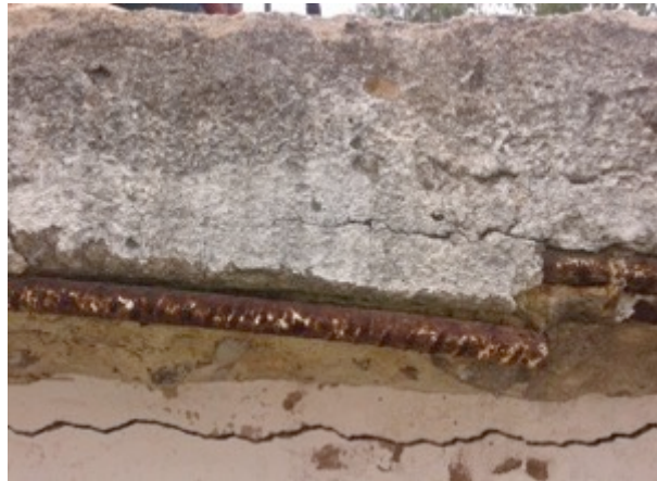
Ilustración 41. Corrosión química del acero
