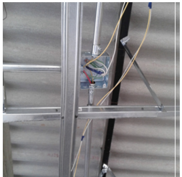
Ilustración 26. Tubería EMT para lámparas
