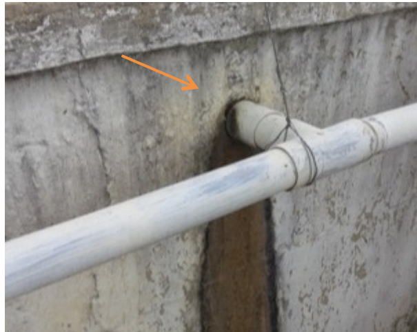
Ilustración 43. Fugas en tuberías externas
