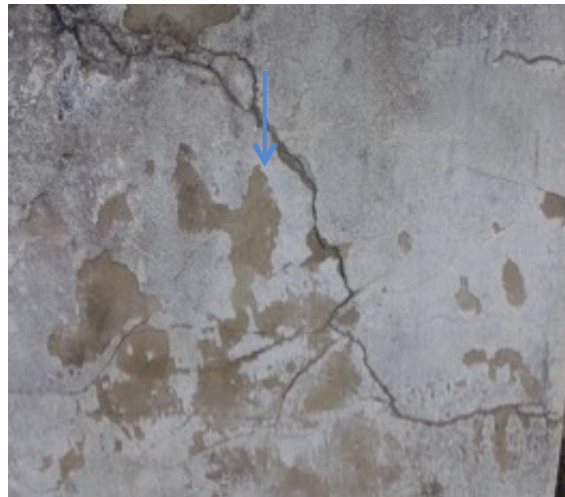
Ilustración 42. Rotura vertical de muros.
