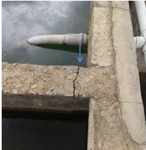
Ilustración 40. Grieta de muros verticales
