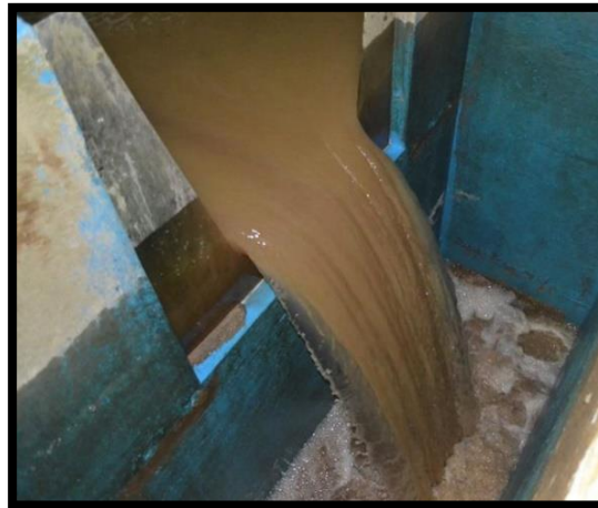
Figura 16. Emergencias por altas precipitaciones PTAP “La Colina” [1].
