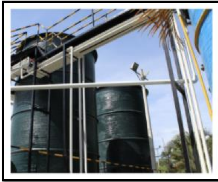
Figura 4. Planta de Tratamiento de Agua Residual PTAR “La Diva” [1].
