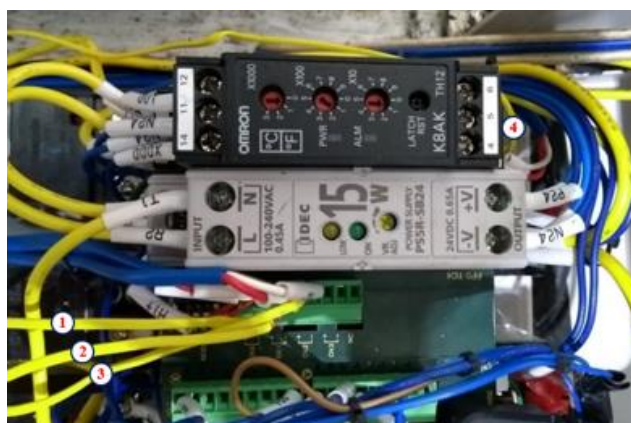
Figura 28. Enlace cableado DAQ a Señales de temperatura.
