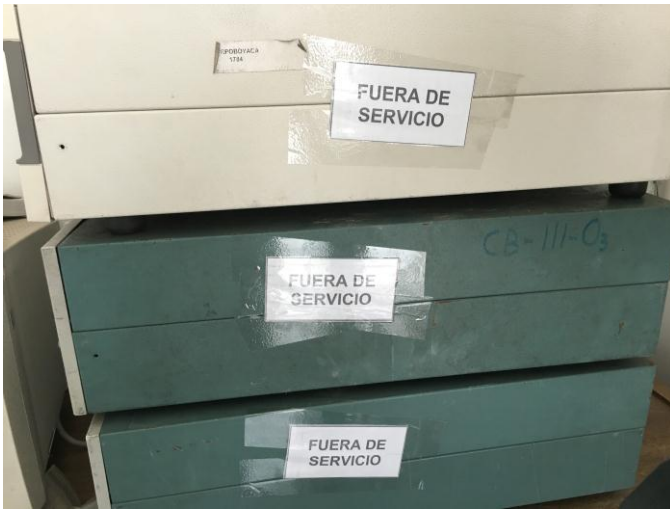
Fig#7: Equipos de estación de Incendies Fuera de servicio.
