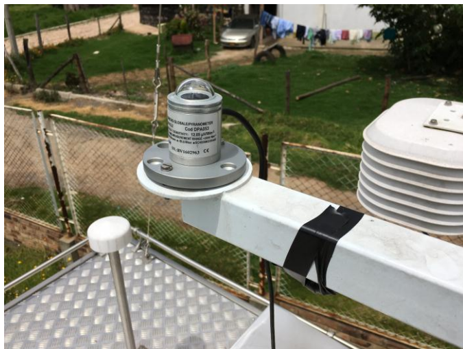
Fig#3: Sensor de repuesto instalado.
