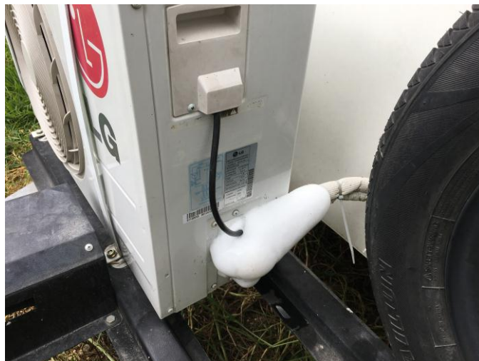
Fig#5: Compresor Aire acondicionado Bomberos.
