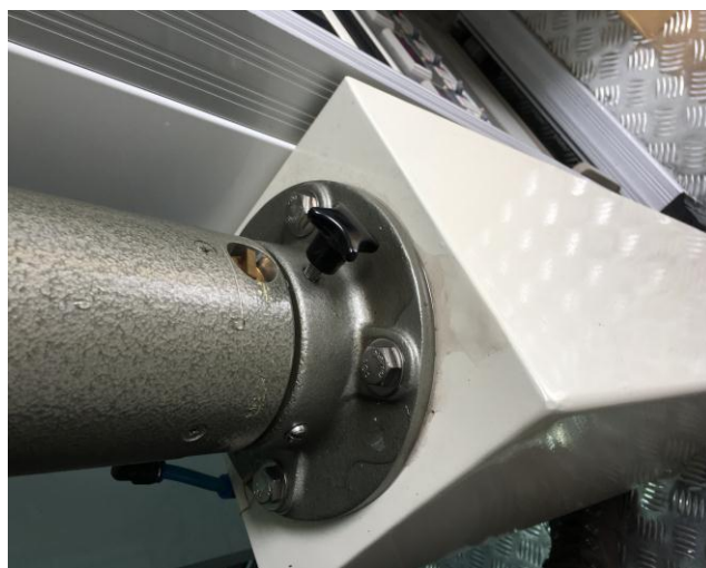
Fig#13: Tubo por donde se filtra agua.
