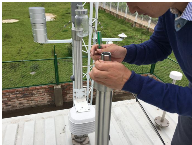
Fig#5: Arreglo fuga PM2.5 Nazareth.
