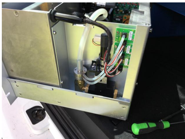
Fig#8: Control Flujo dañado equipo Tunja.
