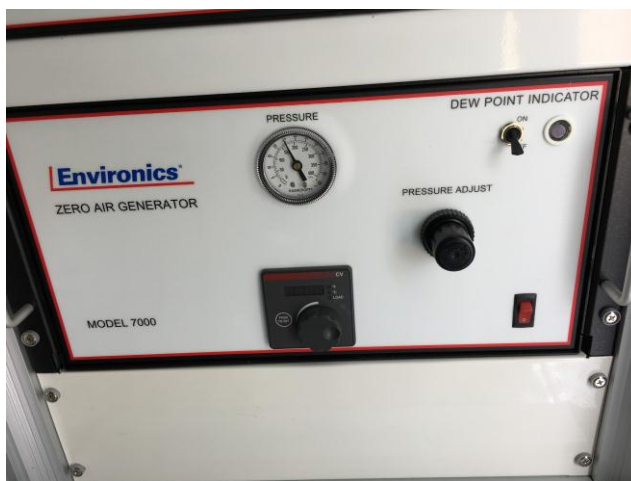
Fig. #21: Generador de aire cero.
