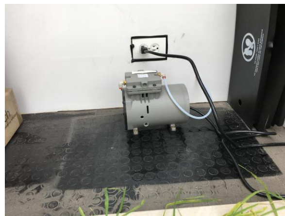
Fig#6: Bomba posicionada en cuarto externo de la estación del SENA.
