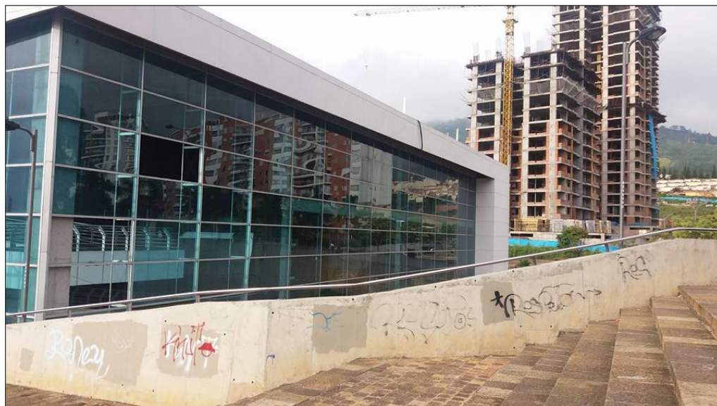
Figura 44. Neomundo fachada en deterioro
