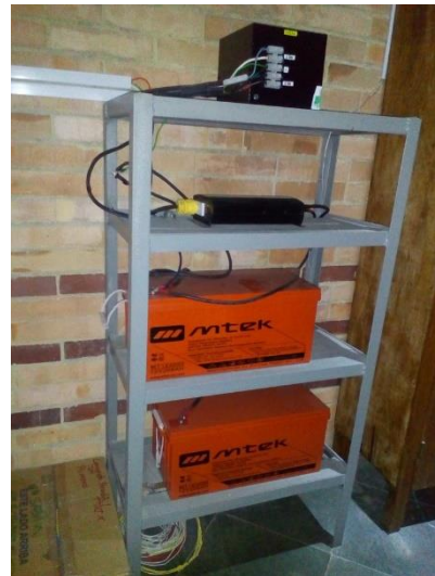
Ilustración 14. Batería Páneles Solares
