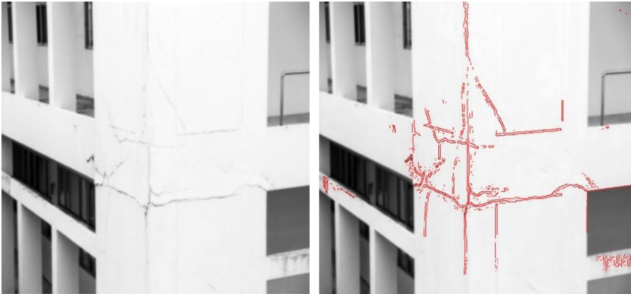
Figura 8 Imágenes representativas de grietas incluidas en el conjunto de datos de grietas y la segmentación utilizada
