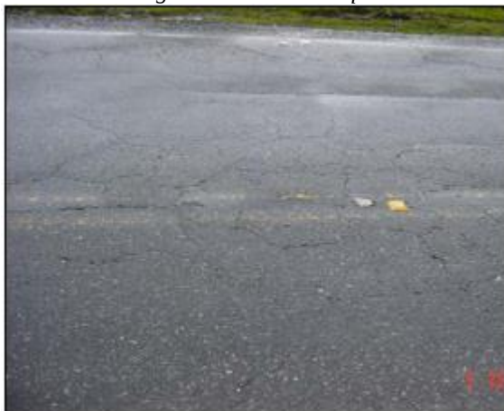
Ilustración 3. Agrietamiento en bloque
