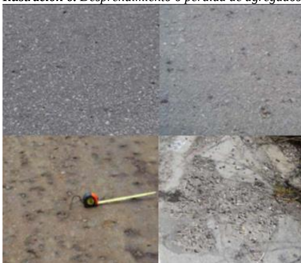
Ilustración 6. Desprendimiento o pérdida de agregados
