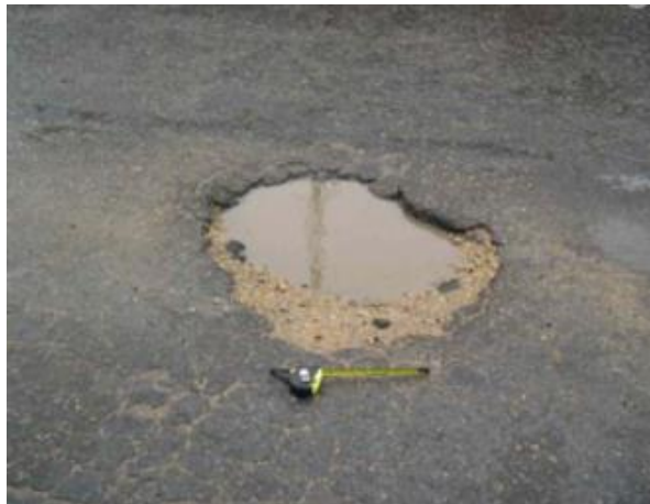
Ilustración 5. Baches o huecos
