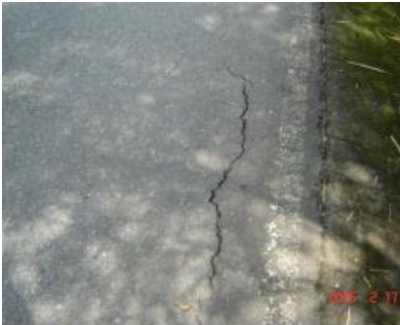
Ilustración 2. . Fisura en los bordes.
