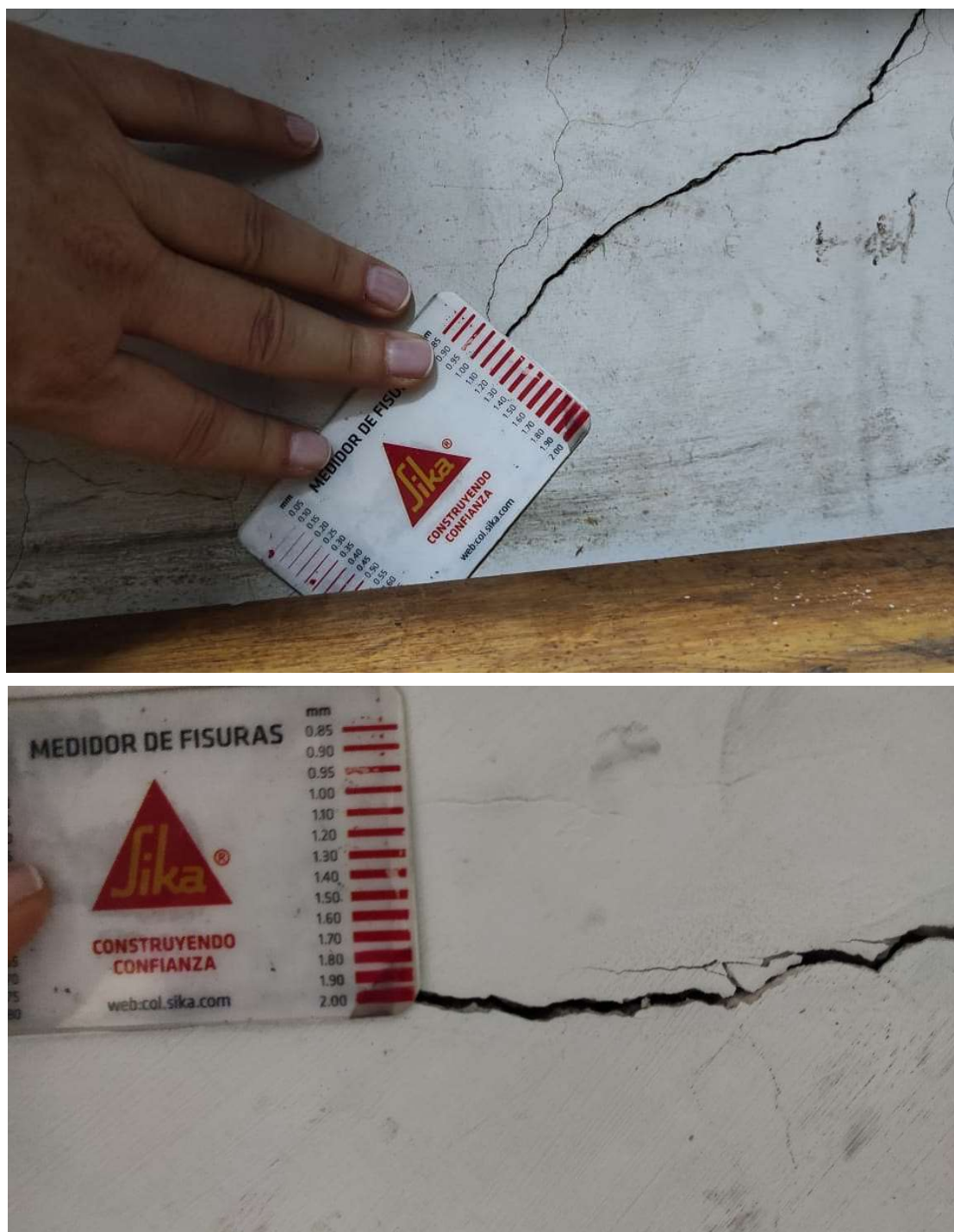
Ilustración 79. Medición de grietas (GM2) en la cara opuesta no resanada del muro. Fuente: Los autores.
