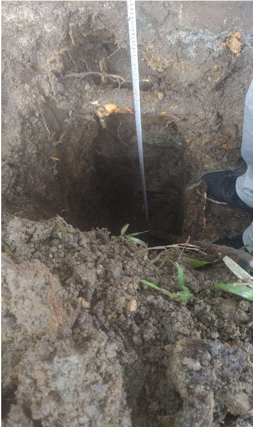
Ilustración 75. Medición de profundidad, evidencia de raíces arbóreas. Fuente: Los autores.
