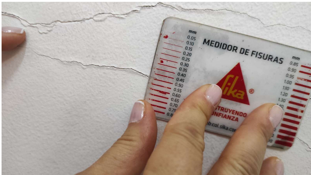
Ilustración 76. Medición de grieta (GM1) en la cara resanada del muro, reparación después de 3 meses aprox. Fuente: Los autores.
