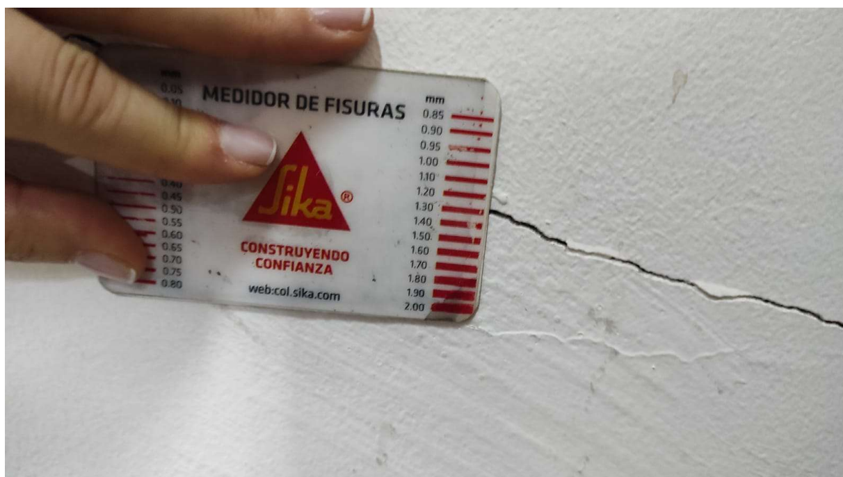
Ilustración 77. Medición de grietas (GM1) en la cara opuesta del muro, fue resanada hace más de un año. Fuente: los autores
