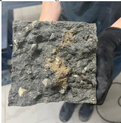
Figura 46. Hormiguero provocado por materia orgánica.
