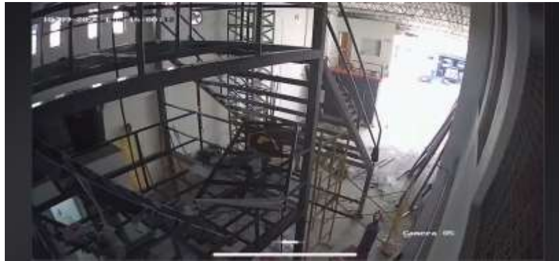
Figura 17 Vista del sistema de seguridad del Centro de Reentrenamiento
