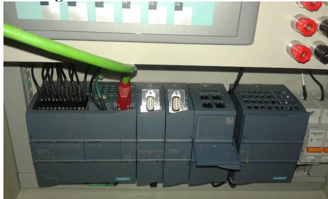
Figura 29. Conexión del PLC S7-1200
