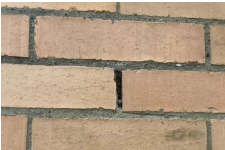
Figura 20. Fachada torre 1 piso 1 con manchas en ladrillos, figuración externa de las unidades y pendientes de boquillas
