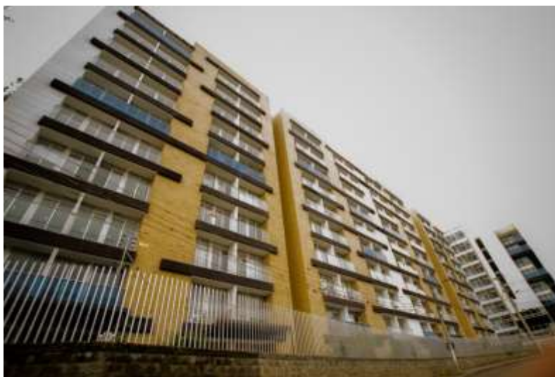
Figura 13. Fachada principal torre 1 Conjunto residencial Frontera Living Apartment, con manchas derivadas de la humedad desde primer piso hasta último
