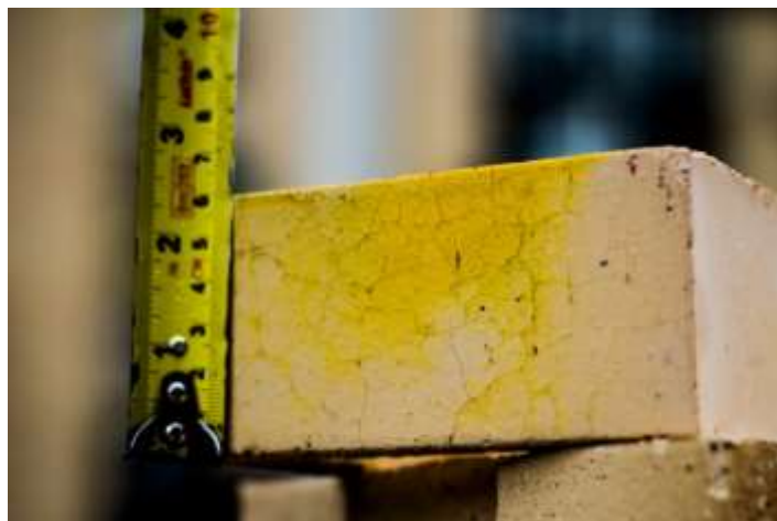
Figura 22. Ladrillo para fachada torre 1 piso 1 con manchas de vanadio y fisuración externa.
