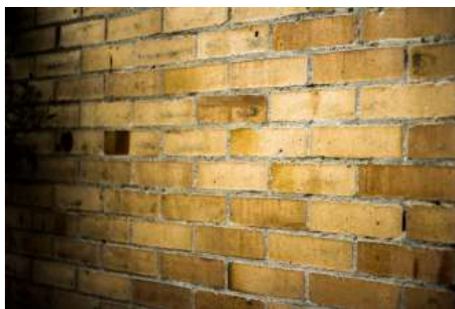
Figura 23. Ladrillo en fachada torre 1 piso 1 con manchas amarillas, marrones y oscuras y fisuración externa.
