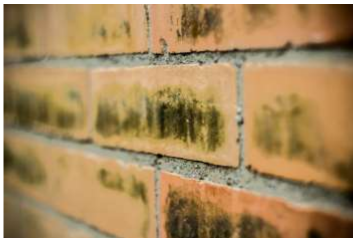
Figura 15. Acercamiento de las manchas en ladrillos derivadas de la humedad por las materas ubicadas en primer piso. Fachada principal Torre 1 Conjunto residencial Frontera Living Apartments
