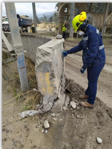
Figura 22: Seguimiento a desprendimiento en muro generado por un cargador en banda transportadora del proceso de almacenamiento y secado de escoria.
