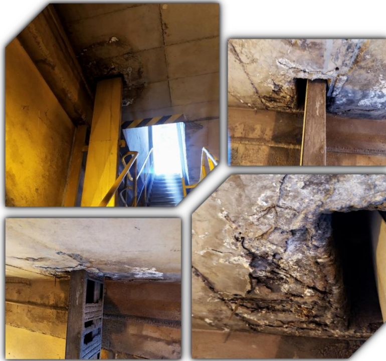
Figura 35: Presencia de carbonatación en placa.
