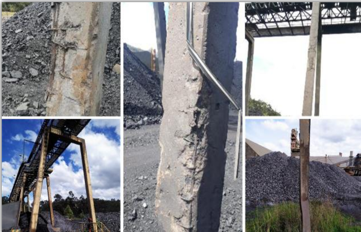
Figura 29: Patologías presentes en banda 360.
