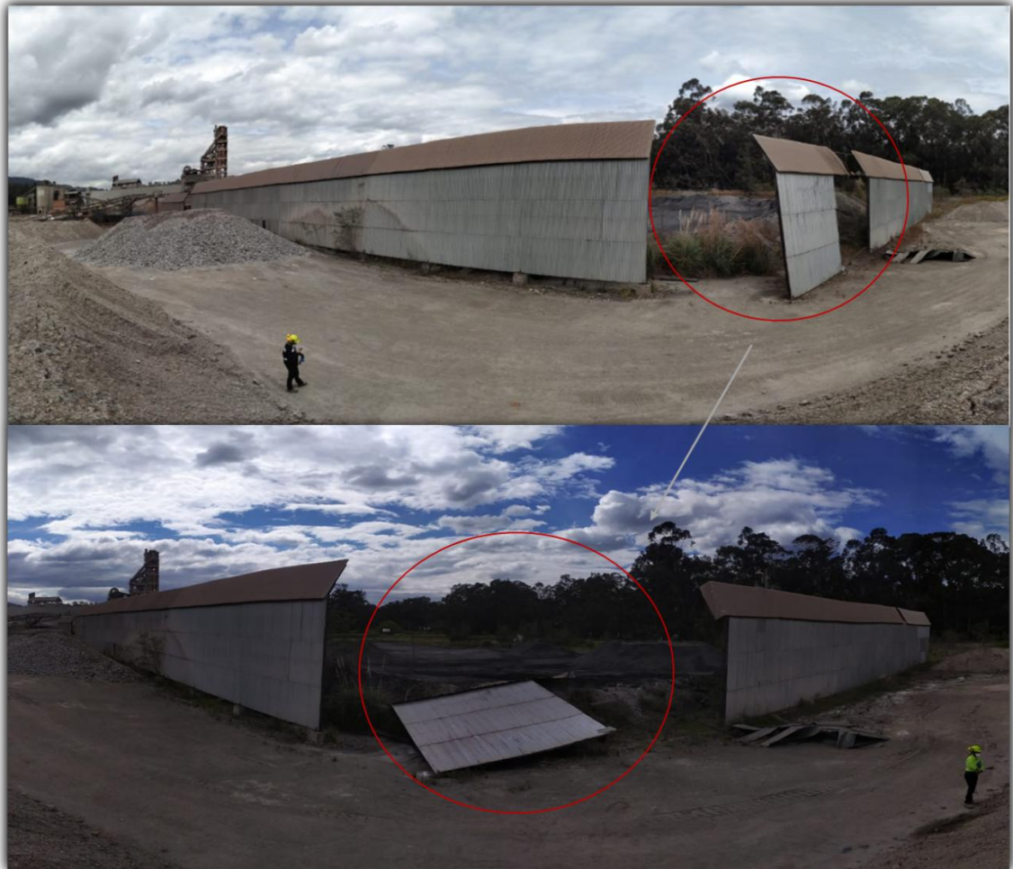
Figura 36: Comparación antes y después de la estructura que colapsó.
