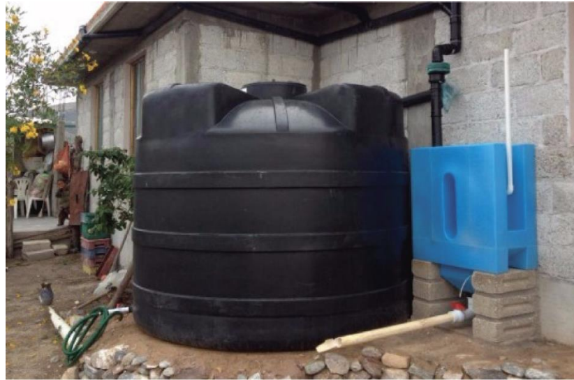
Recolección de aguas lluvias
