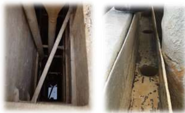
Ilustración 7. (a) Cámara de floculación (b) Canaleta de rebose
