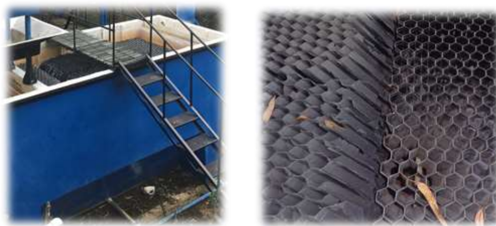
Ilustración 8. (a) Sedimentador (b) Módulos laminares
