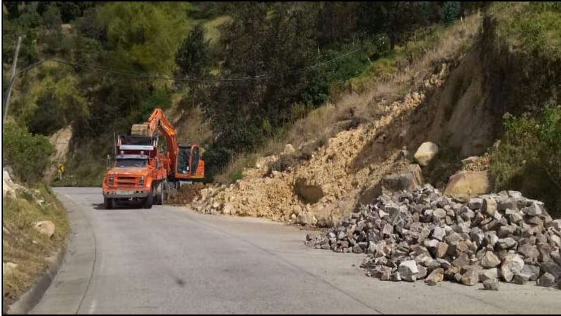
Fotografía 4. Remoción de material por derrumbe PR 74
