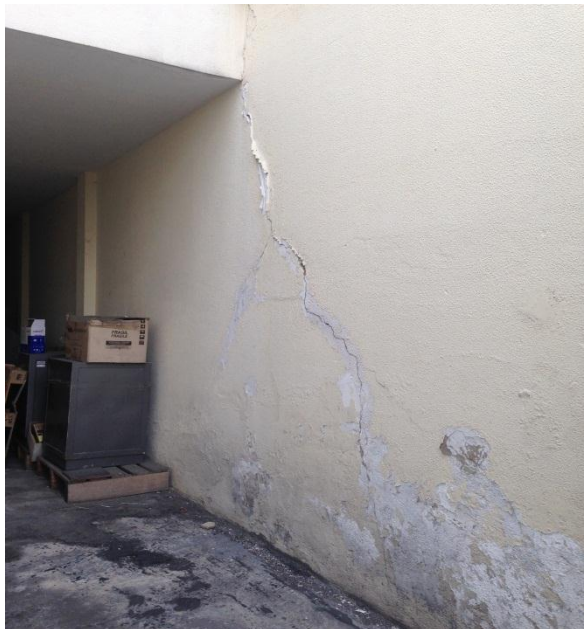
Fotografía 3-5 Humedad en pared edificio Publicaciones
