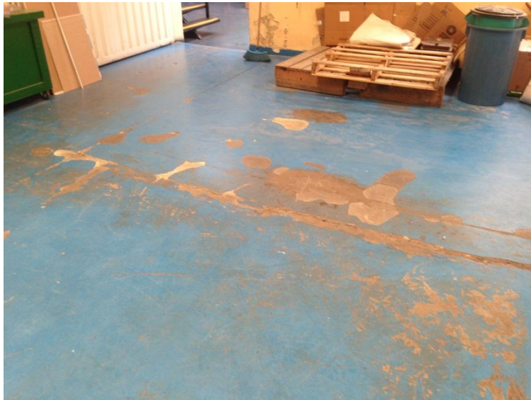
Fotografía 3-4 Evidencia piso en mal estado
