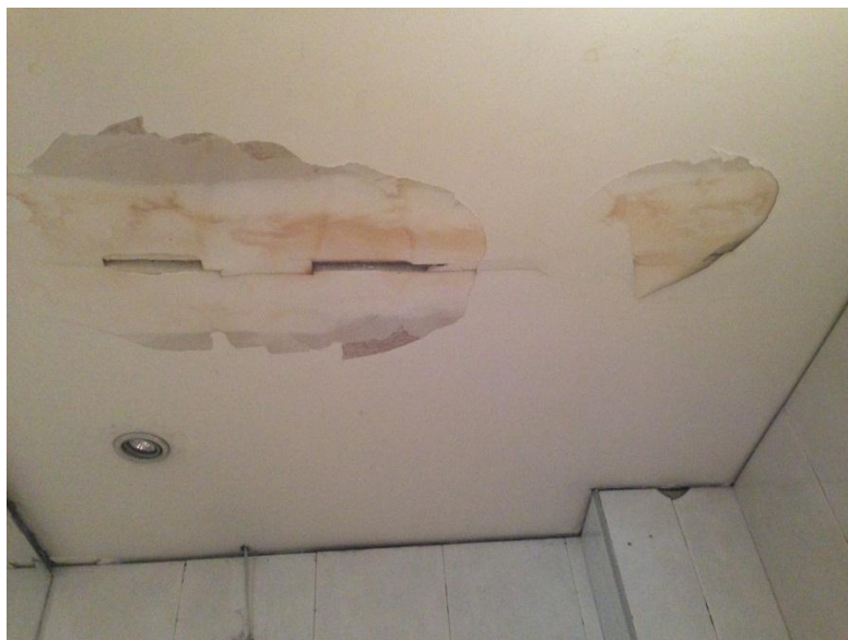
Fotografía 3-3 Evidencia humedad en techo edificio Santo Domingo
