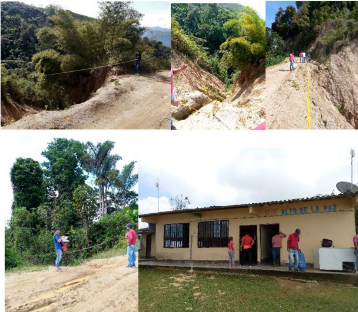
Figura 14 Visita a la vereda del Alto de La Paz por desbancamiento vial en dos tramos.
