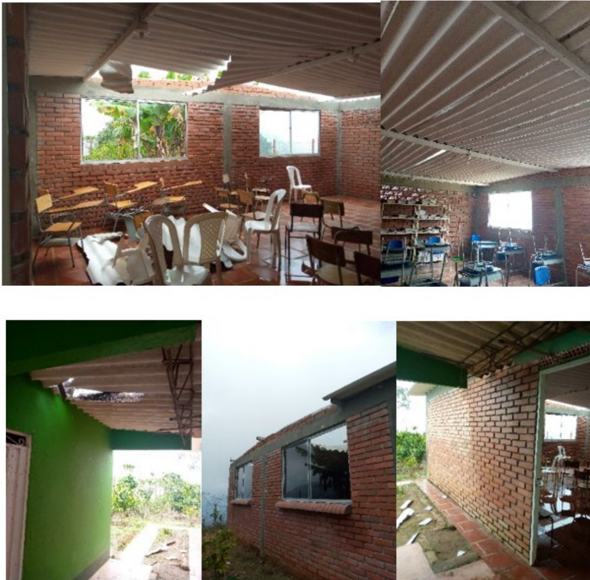
Figura 13 Visita a la escuela del Filo por vendaval y mal estado de los salones.
