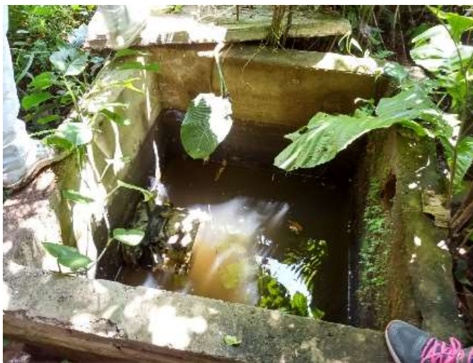
Figura 3. Tanque de entrada de excreta y orina porcina.
