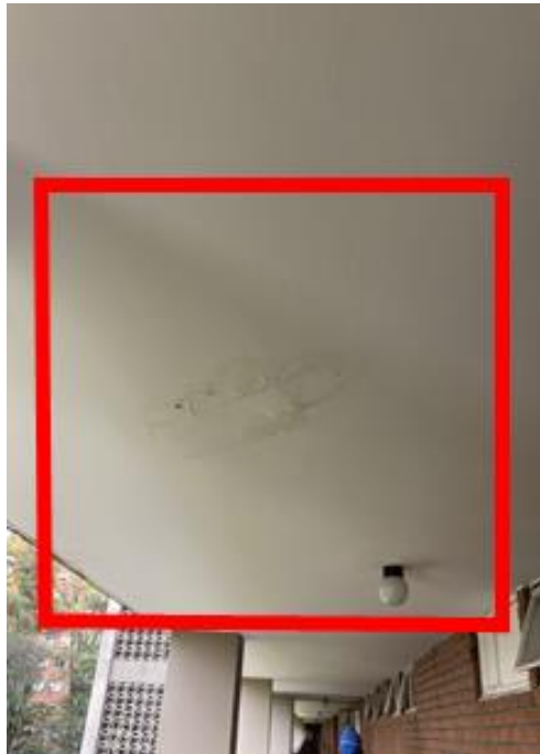
Ilustración 4. Humedad por filtración y accidental. Autores.
