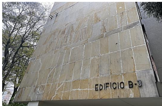
Ilustración 9. Fisuras por acabado. Autores.
