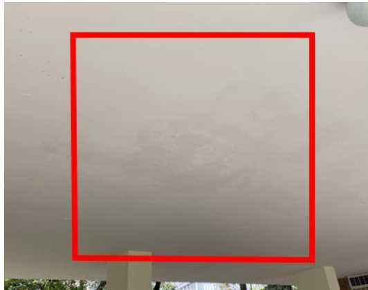
Ilustración 2. Humedad por obra. Autores
