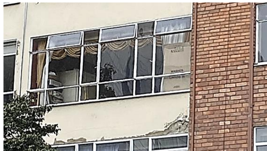
Ilustración 11. Desprendimientos por acabado continuo. Autores.
