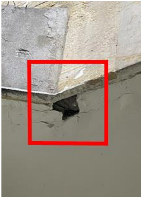
Ilustración 10. Desprendimiento de placa. Autores.
