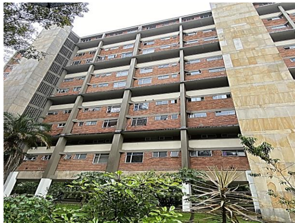
Ilustración 7. Erosión atmosférica. Autores.
