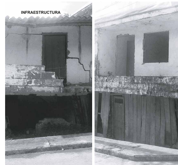
Figura 18. Nota: Deterioro infraestructuras Calle10 - Carr 9 Fuente: Fotografía propia
