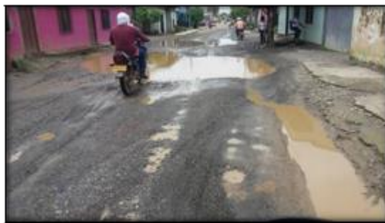
Figura 5 Acumulación de aguas en la calle 12- Barrio 19 de Marzo (fuente: propia)
