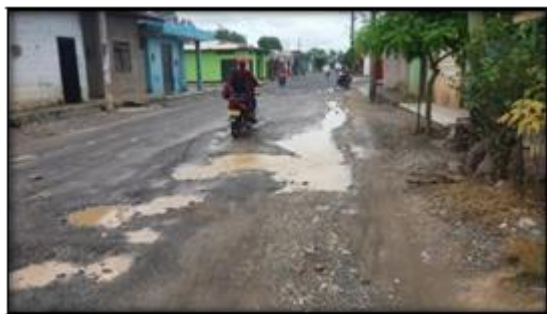
Figura 4 Estado vial calle 12 – Barrio 19 de Marzo (fuente: propia)
