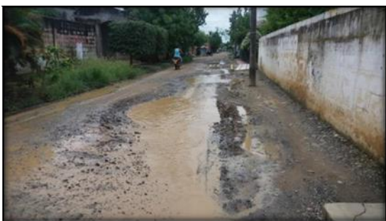
Figura 2 Estado de la calle 12 - barrio 19 de Marzo (fuente: autoría propia)
