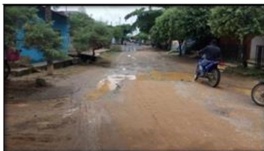
Figura 7 Mal estado de la calle 9- Barrio 19 de Marzo (fuente: propia)
