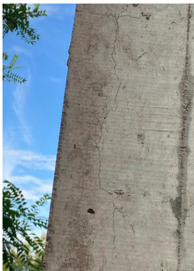
Fotografía 8 lesión 3 encontrada. Fuente: Propia
