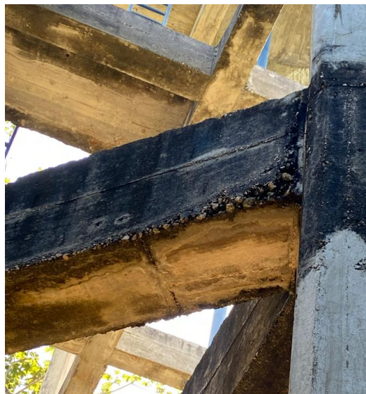
Fotografía 14 lesión 7 encontrada. Fuente: Propia
