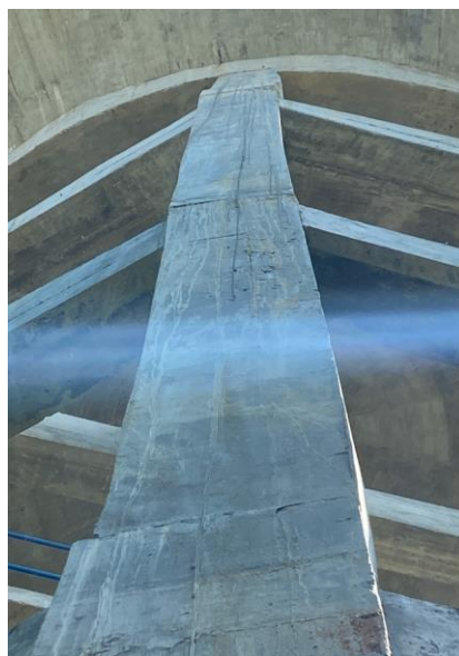
Fotografía 13 lesión 6 encontrada. Fuente: Propia
