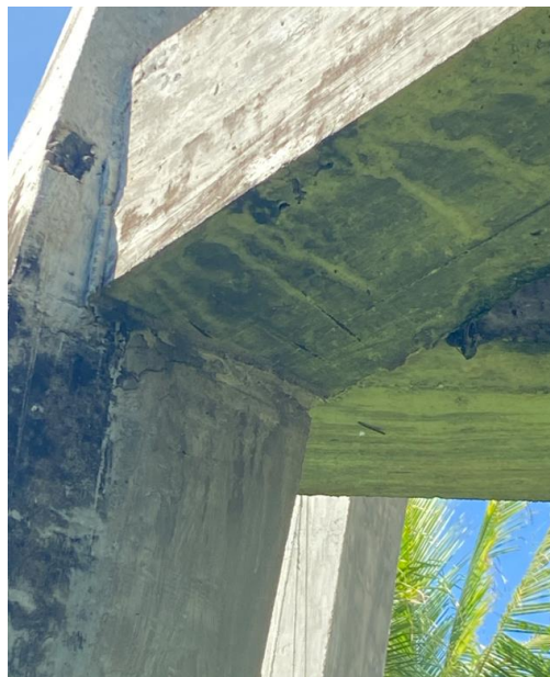
Fotografía 15 lesión 8 encontrada. Fuente: Propia
