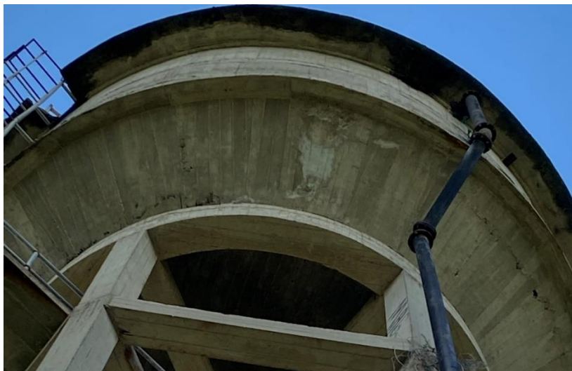
Fotografía 6 lesión 1 encontrada. Fuente: Propia
