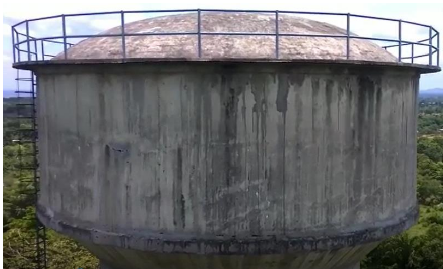
Fotografía 7 lesión 2 encontrada. Fuente: Propia
