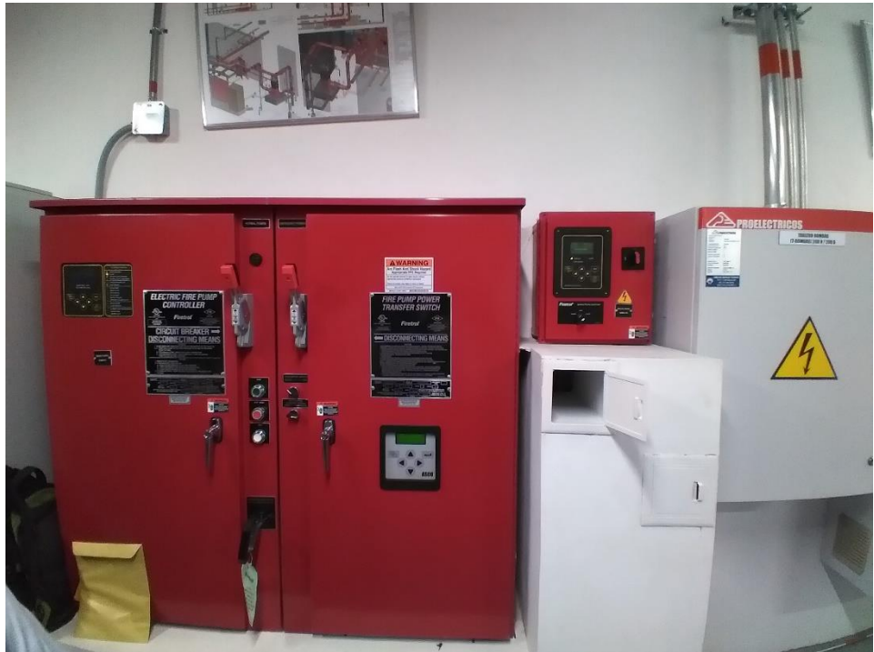
Figura 9. Control automático de la bomba principal
