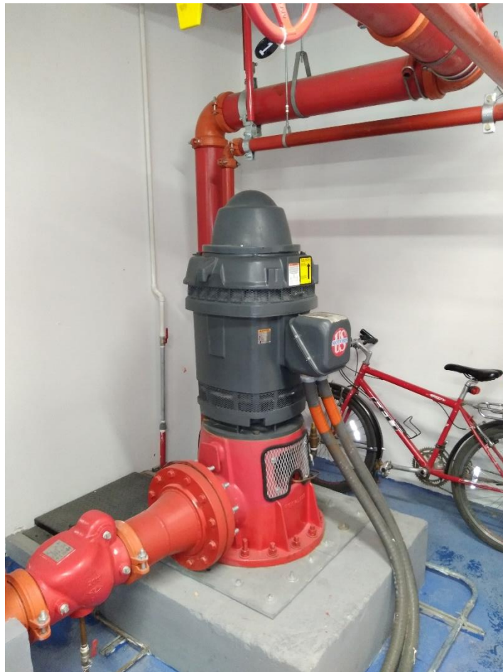
Figura 6. Bomba de tipo turbina vertical.
