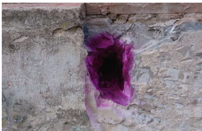
Foto 7. Ensayo para determinar la profundidad de carbonatación en el concreto. (Fuente Elaboración propia).
