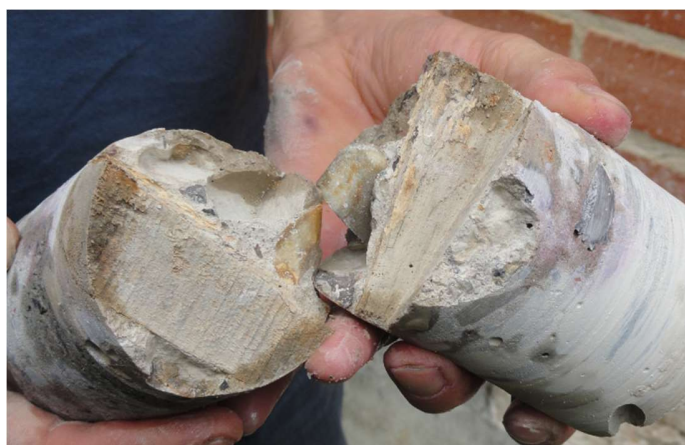
Foto 6. Contaminación en núcleo de concreto. (Fuente Elaboración propia).
