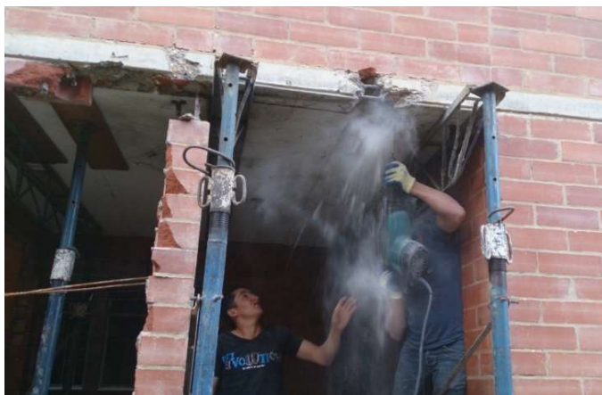
Foto 9. Exploración de losetas sobre viga. (Fuente Elaboración propia).
