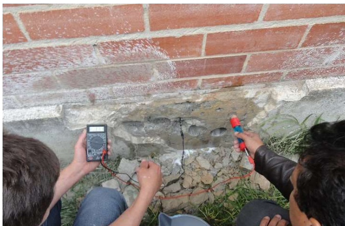
Foto 8. Medición de potenciales de corrosión con media celda de cobre sulfato. (Fuente Elaboración propia).
