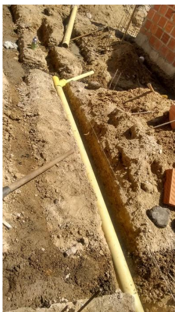
Foto 43. Red sanitaria en uno de los proyectos.
