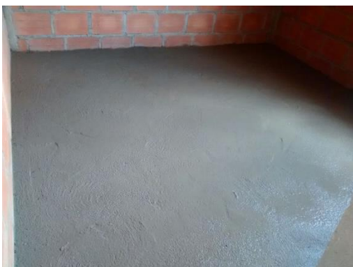
Foto 24. Piso en concreto en uno de los proyectos.
