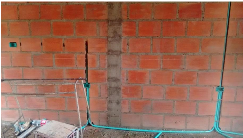
Foto 40. Punto eléctrico 110 V en uno de los proyectos.
