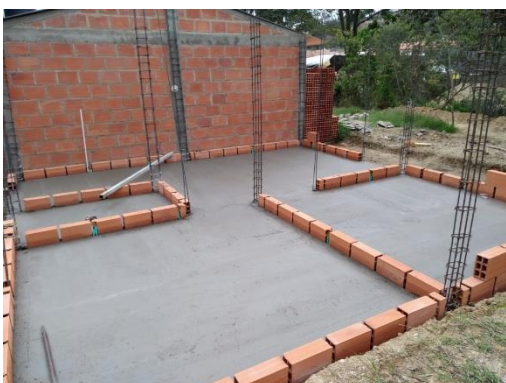
Foto 25. Piso en concreto en uno de los proyectos.
