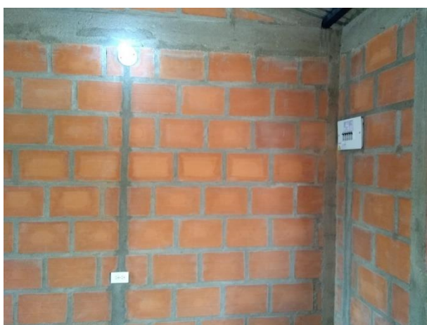
Foto 37. Punto eléctrico de iluminación en uno de los proyectos.
