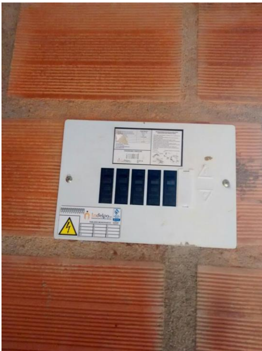
Foto 36. Caja de circuitos en uno de los proyectos.
