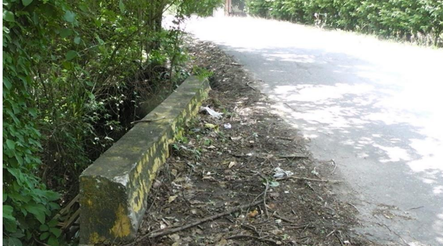
Figura 21 Ausencia de junta, puente K6+996
