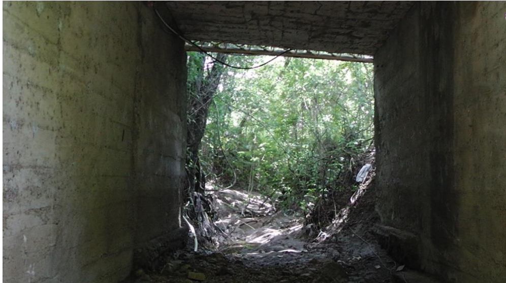
Figura 27 Estado del cauce puente K6+996
