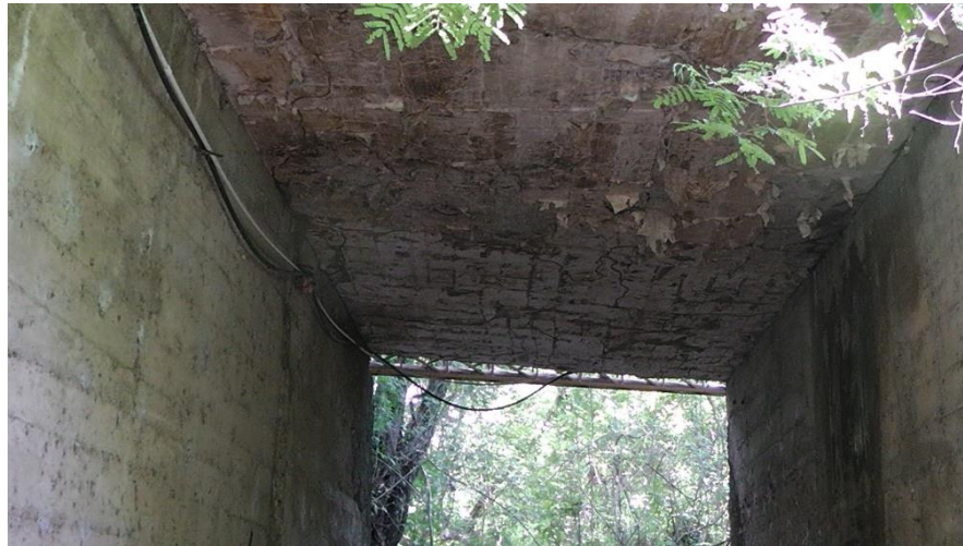
Figura 25 Ausencia dispositivo de apoyo, puente K6+996
