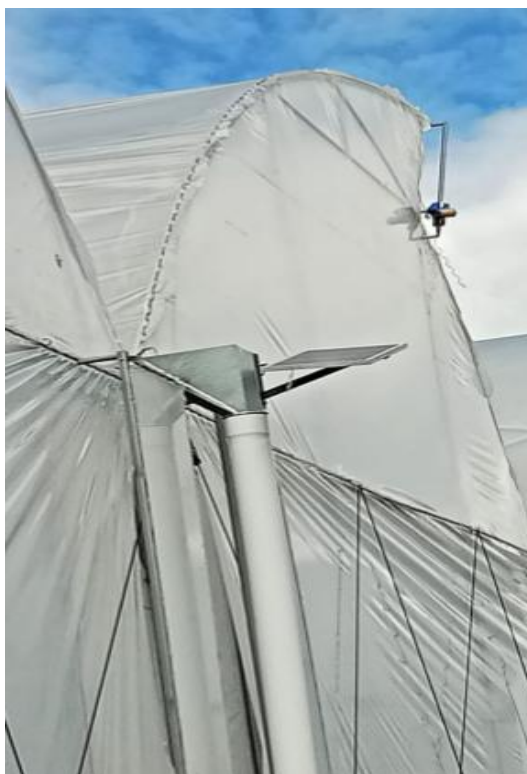
Figura 56 Instalación Completa Del Motor Y El Panel Solar
