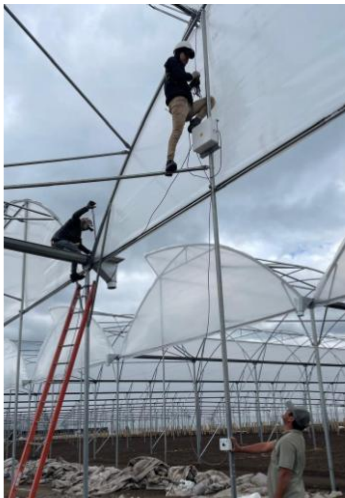
Figura 62. Instalación Caja IP Dentro Del Invernadero.
