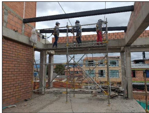
Fotografía 3. Perfilera instalada. Fuente propia
