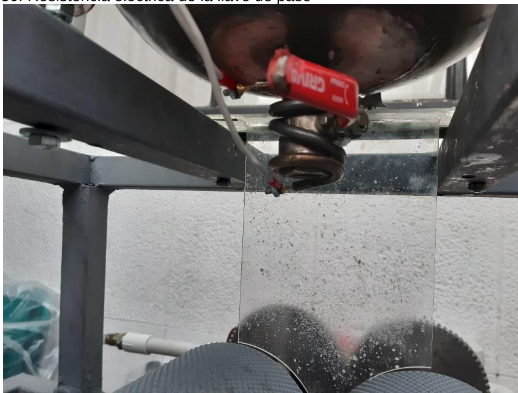
Figura 50. Resistencia eléctrica de la llave de paso
