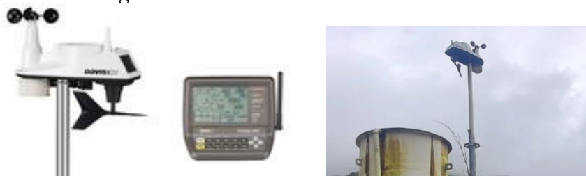
Figura 2. Estación meteorológica instalada.
