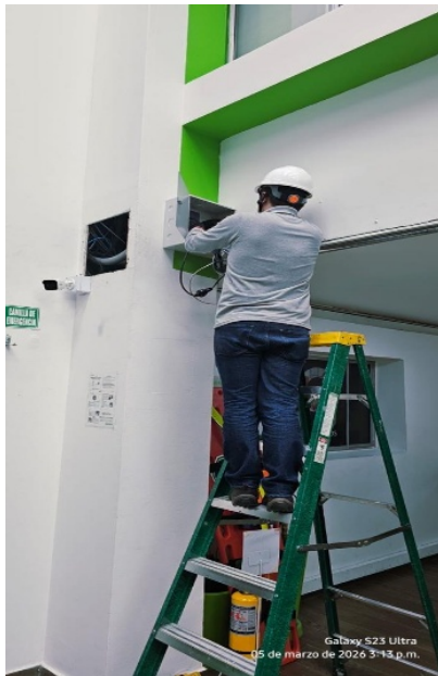
Figura 6.1: Instalación y ajuste de una cámara de videovigilancia en infraestructura interior.
