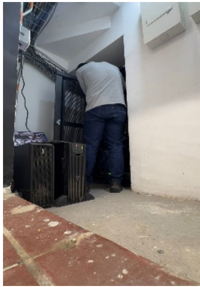
Figura 3.3: Inspección directa sobre un gabinete o rack técnico durante el levantamiento del inventario.
