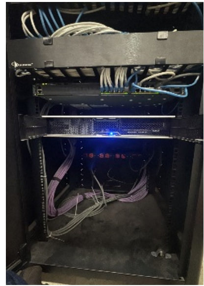
Figura 3.4: Punto de infraestructura técnica con conexiones y equipos activos del sistema.
