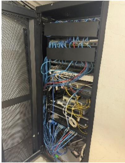
Figura 3.2: Rack con elementos de cableado y distribución asociados a la infraestructura de seguridad electrónica.
