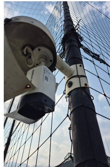
Figura 6.9: Cámara tipo bala en estado deteriorado.
