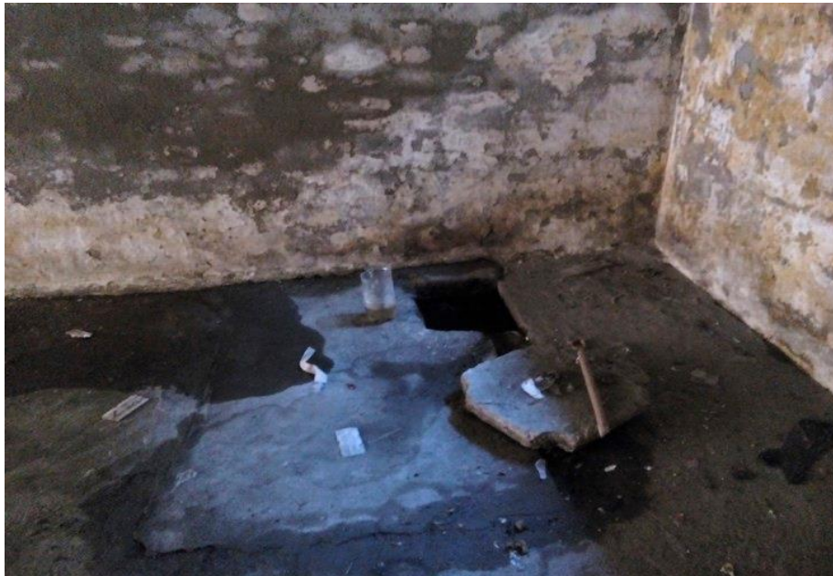
Imagen 41. Detalle registro de captación de aguas lluvias. Falta de pendientes. Fuente: Autores.
