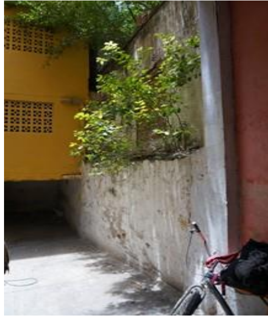
Imagen 43. Muro interno divisorio sobre el que ha crecido vegetación. Las raíces están realizando empuje sobre el muro. Fuente: Autores.
