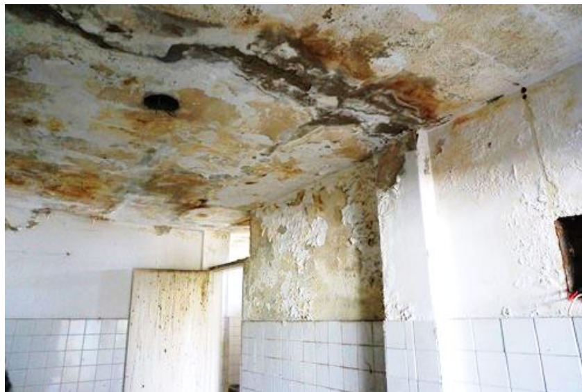
Imagen 19. Detalle lesiones por Humedad reflejada en el cielo raso del cuarto piso. Fuente: Autores.
