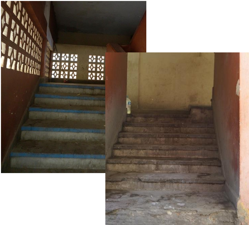
Imagen 45. Detalle del estado de las escaleras a lo largo de todo el edificio. Fuente: Autores.
