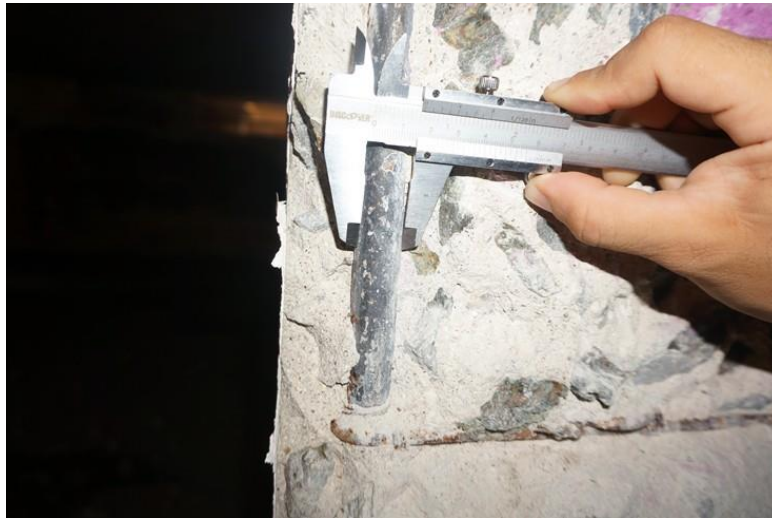
Imagen 52. Detalle medida de los espesores y estado de los aceros de refuerzo existentes. Fuente: Autores.
