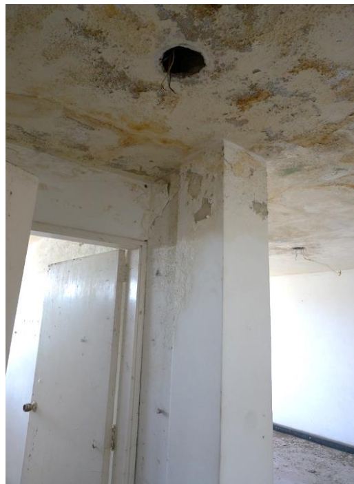
Imagen 35. Detalle la cubierta y la zona inferior (cielo raso). Manchas de óxido, desprendimientos de pintura y daños en las redes eléctricas. Fuente: Autores.
