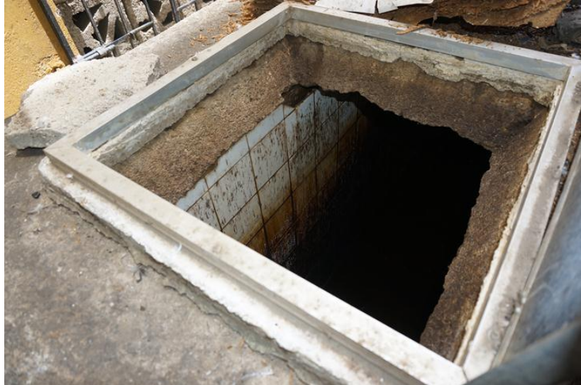
Imagen 30. Detalle del interior del tanque. Totalmente sucio e inoperativo.
