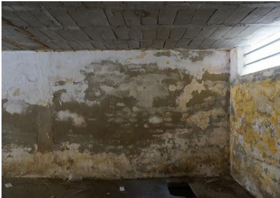
Imagen 40. Detalle de las fachadas internas. Semisótano. Se aprecia la humedad ascendente por capilaridad, prácticamente ya cubre la altura total de los muros. Fuente: Autor.
