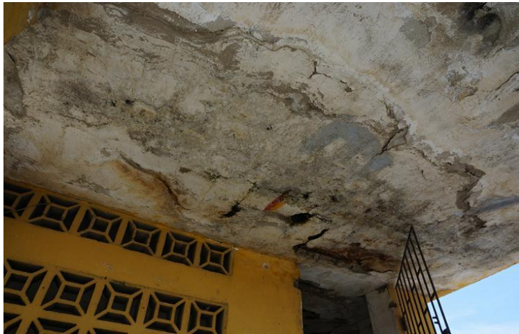
Imagen 32. Detalle de la zona inferior de la losa de soporte de los tanques. Se aprecia el desprendimiento del concreto y los aceros de refuerzo en avanzado estado de oxidación. Voladizo eterno. Fuente: Autores.
