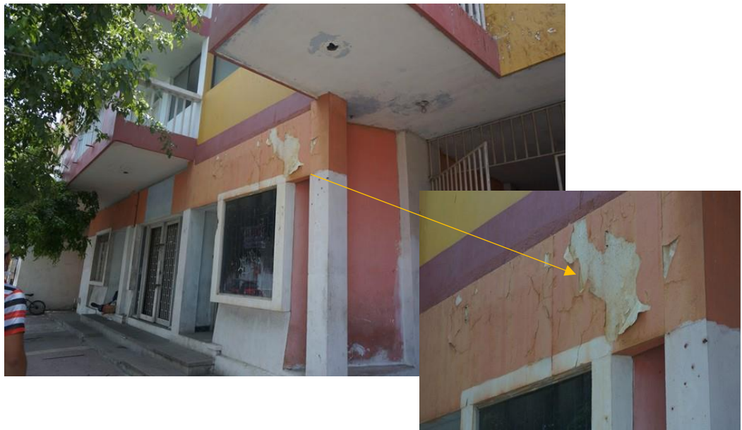
Imagen 38. Detalle fachada exterior Manchas de óxido, suciedad y desprendimiento de las pinturas. Fuente: Autores.
