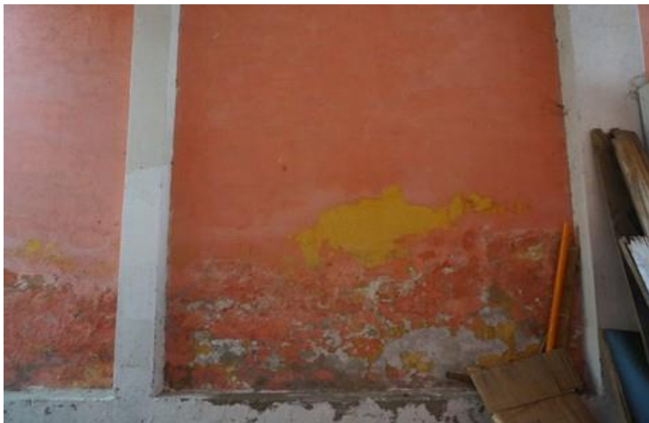
Imagen 42. Detalle humedad ascendente. Pasillo de acceso al semisótano. Fuente: Autores.
