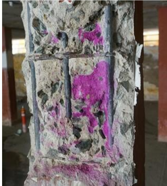
Imagen 54. Detalle del estado de corrosión de los flejes en la columna I3. Fuente: Autores.
