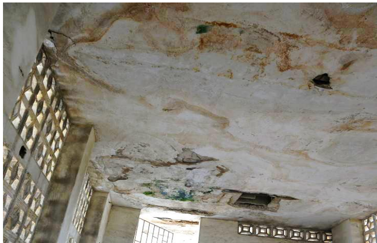
Imagen 33. Detalle de la estructura de soporte de los tanques elevados. La mancha de óxido confirma de despasivación del acero y las manchas verdes presencia de acumulación de materia orgánica formada por la caída de agua. Fuente: Autores.
