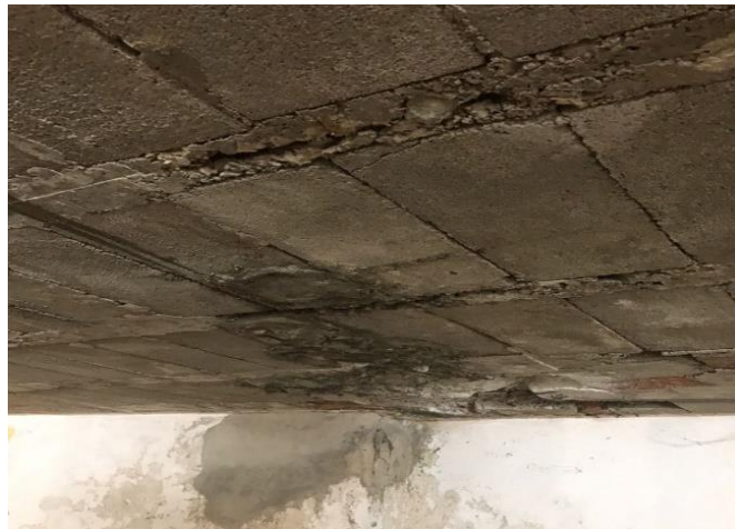
Imagen 46. Detalle del estado de las viguetas y plaquetas del primer nivel. Fuente: Autor.
