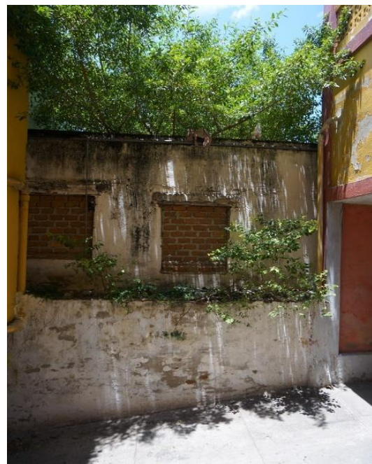
Imagen 44. Muro interno divisorio sobre el que ha crecido vegetación. Fuente: Autores.
