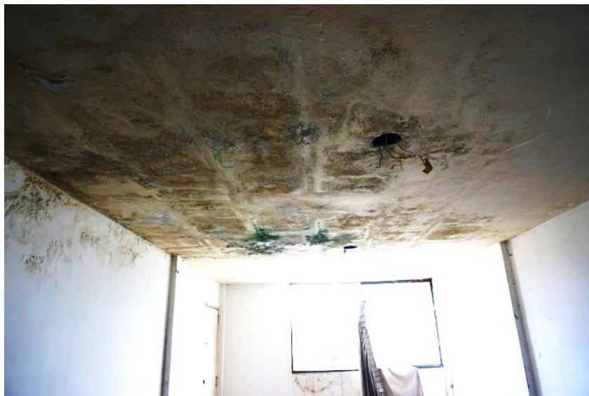
Imagen 37. Detalle cielo raso Manchas de óxido, manchas de color verde (materia orgánica) se aprecian las marcas de las viguetas de la losa. Fuente: Autores.
