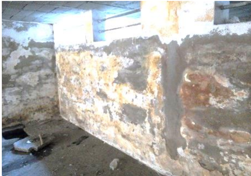
Imagen 18. Detalle lesiones por Humedad en los muros del semisótano. Fuente: Autores.
