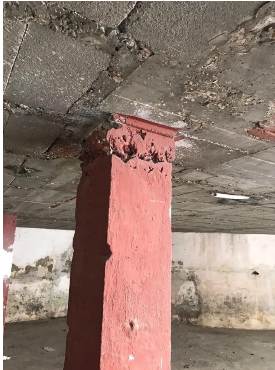
Imagen 20. Detalle lesiones generadas por deficiencias en los métodos constructivos. Fuente: Autores.
